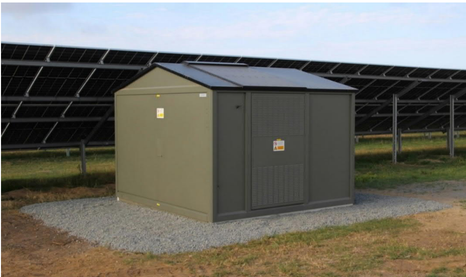
Figur 15. Exempelbild som visar en transformatorstation. Bildkälla: Landinfra.
