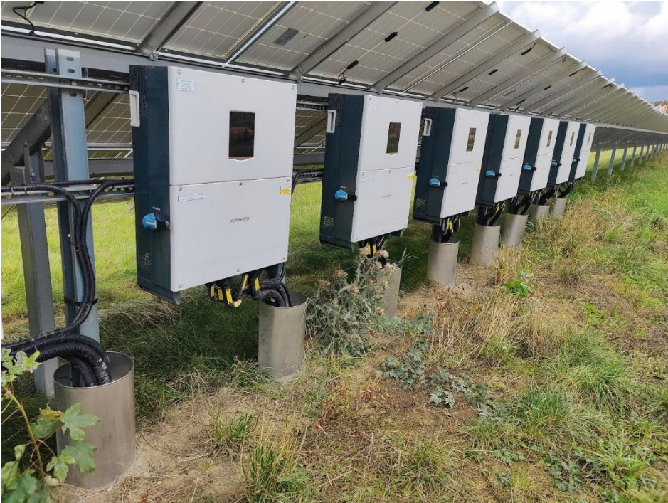
Figur 14. Exempelbild som visar växelriktare på stativ. Bildkälla: Sweco.
