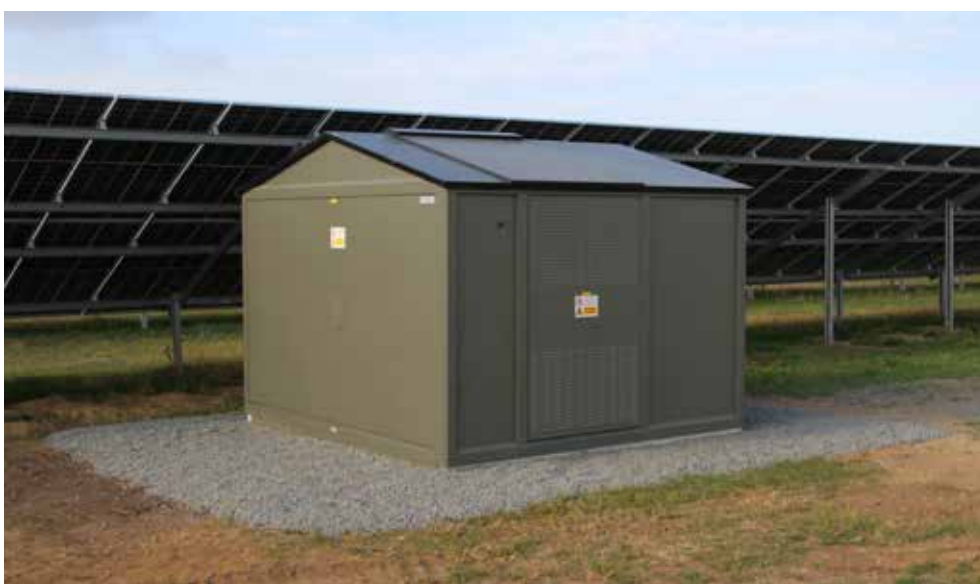
FIGUR 13 Exempel på transformatorställverk (Foto: Martin Windh, Landinfra).
