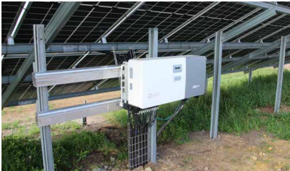
FIGUR 11 Exempel på växelriktare som monterats på markställning (Foto: Martin Windh, Landinfra)..
