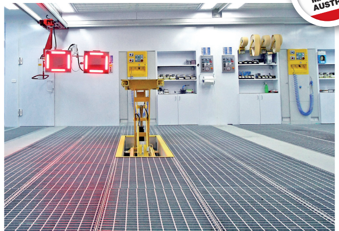
Vorbereitungsplatz mit Gitterberostung inklusive Hebebühne und Rahmen mit Deckenfiltern
