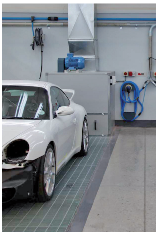
Vorbereitungsplatz mit Gitterberostung, Rahmen und Abluftaggregat
