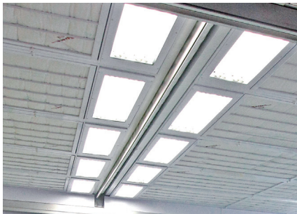
Zuluftdecke, Rahmen mit Beleuchtung und elektrischem Vorhang
