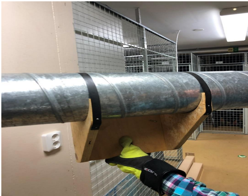
Bild 22. Frånluftskanal (väggmonteras mellan toalettavdelningen och gasfånget, vid skyddsrumsdörren)
