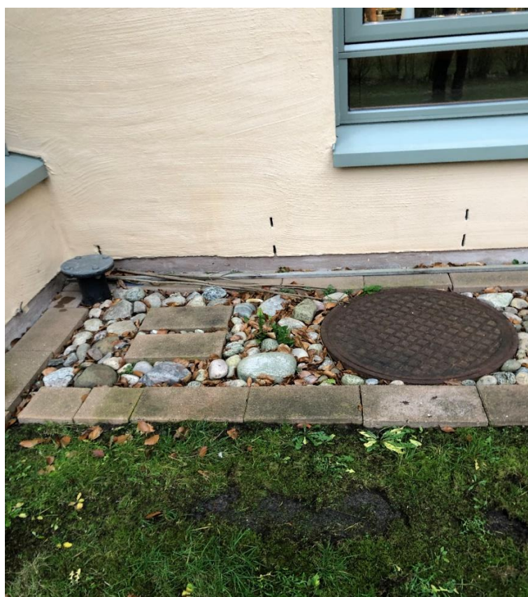
Bild 34. Till vänster: plats (fläns på röret) för montering av uteluftskanal Till höger: öppning för reservutgång väster (under stora runda järnlocket på mark)
