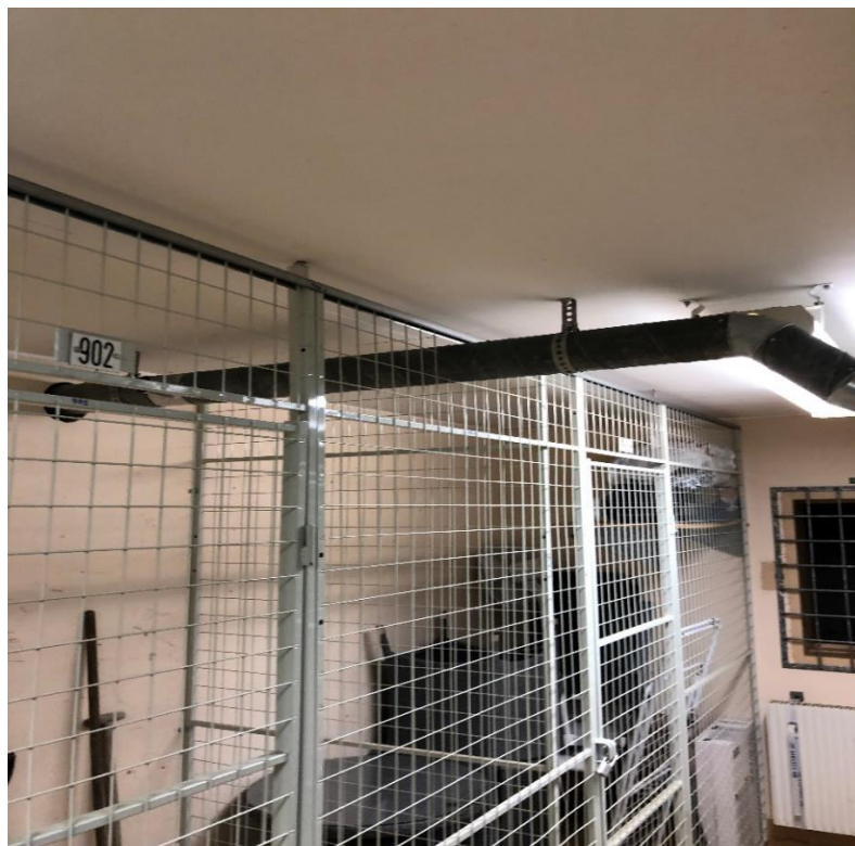
Bild 14. Tilluftskanaler (är monterade i taket)
