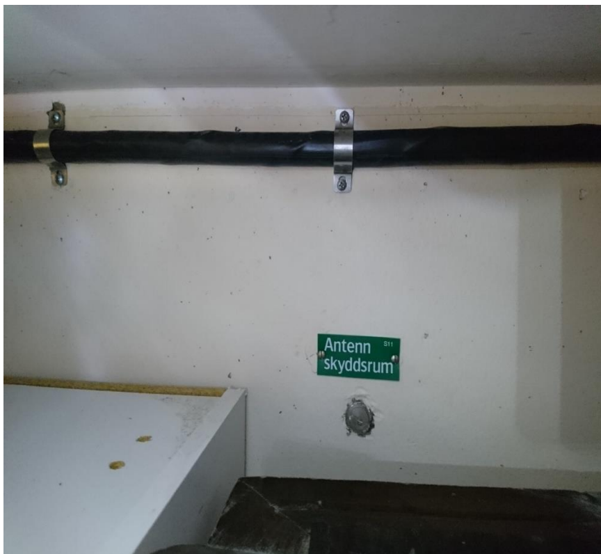
Bild 6. Genomföring för antenn
