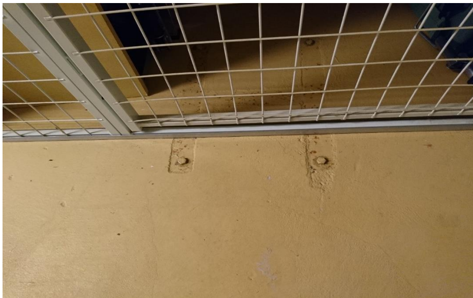
Bild 12. Infästningsram (med bultar i golvet) för luftrenningsaggregat (väster)
