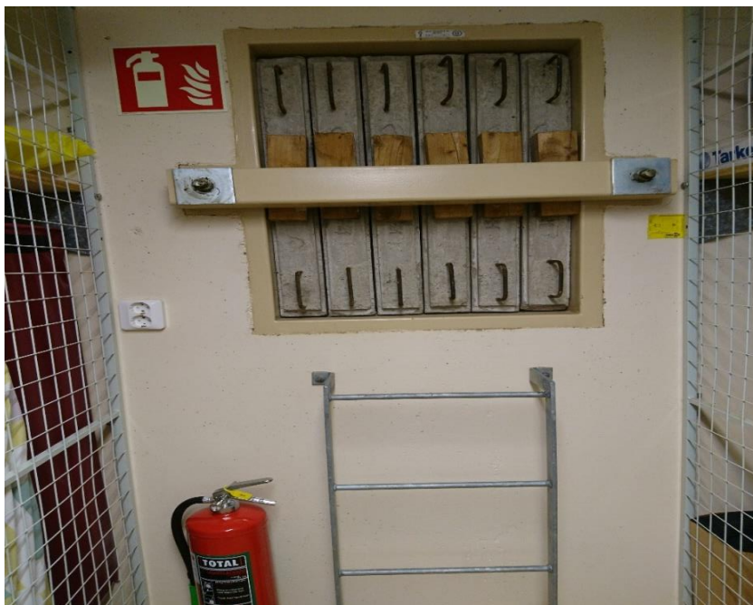
Bild 28. Reservutgång öster igensatt (6 betongelement, fördelningsbalk, 2 rundstänger och 6 tråkilar)
