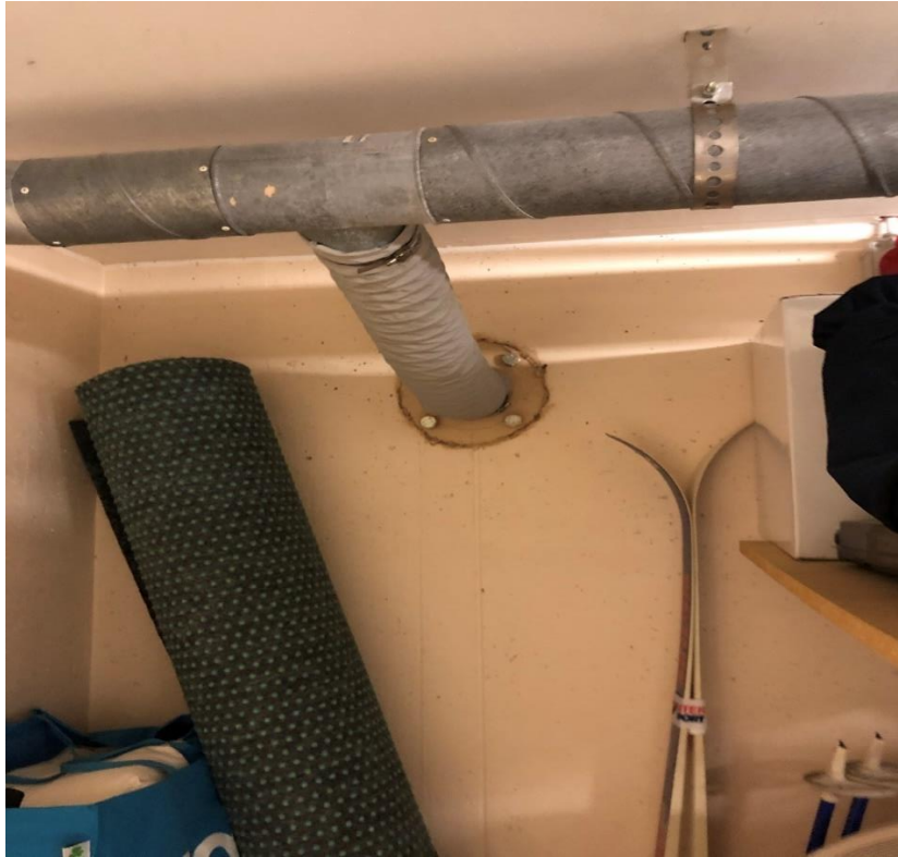
Bild 9. Fläns (2 st) dit stötvågsventilerna ska anslutas, samt del av tilluftskanalsystemet i taket
