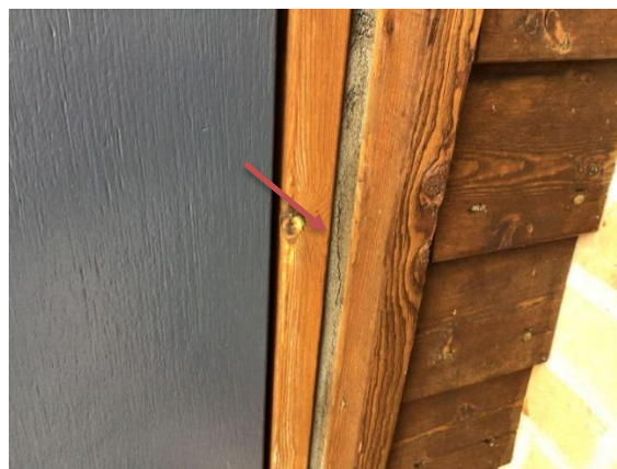
Generelt registreres der nedbrydning af fuger på alle enheder.
