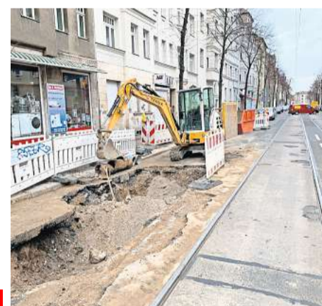
Nach einem Wasserrohrbruch ist die Gorkistraße gesperrt.
