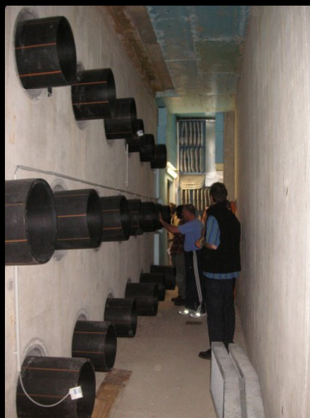
Figur 2.0: Det kæmpemæssige ventilationsanlæg til fordeling af luftbaseret jordvarme i et passivhus Kilde: Ellehaug og Kildemoes
