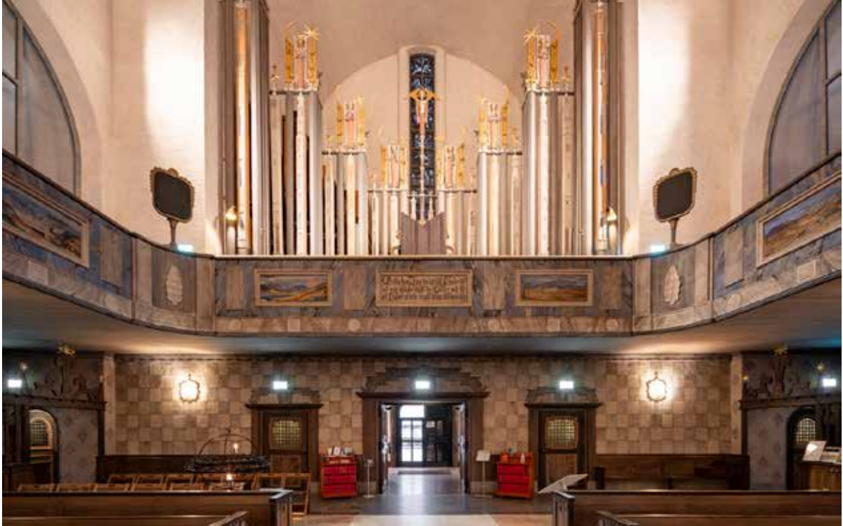
Luftrenarna är installerade på orgelläktarna i Högalids kyrka. Foto: Anders Bobert.
