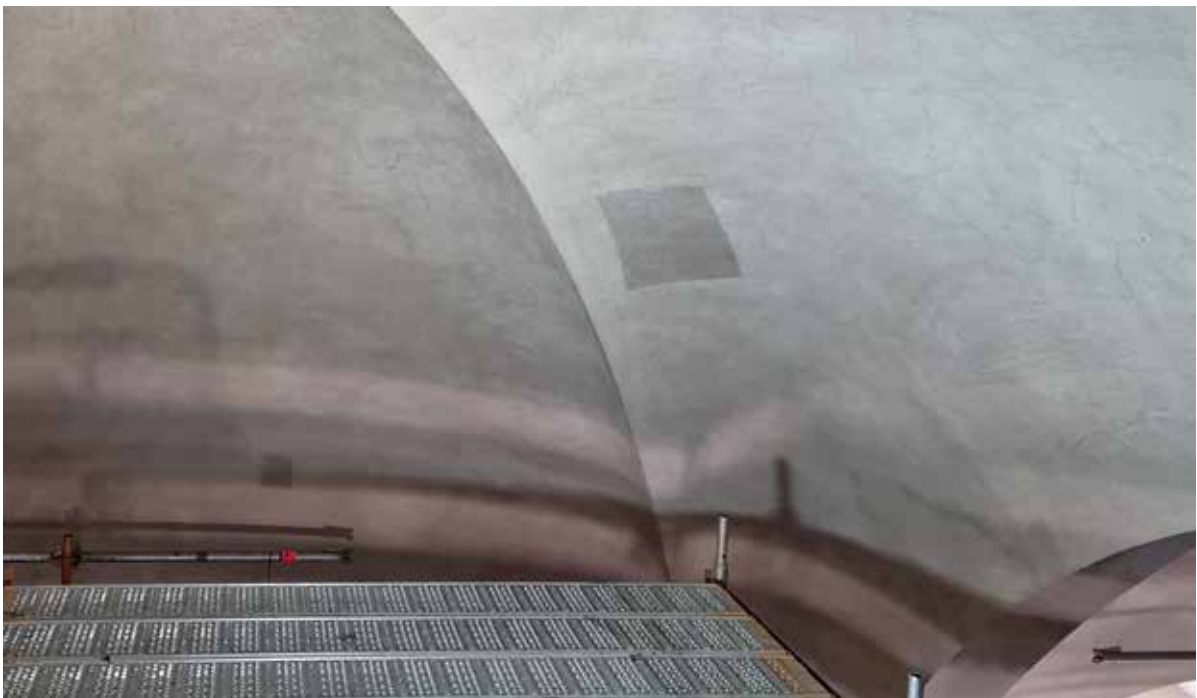
Den mörkare rutan på väggen i Staffans Kyrka Gävle är ej rengjord för att visa skillnaden. Foto: Robert Edman.
