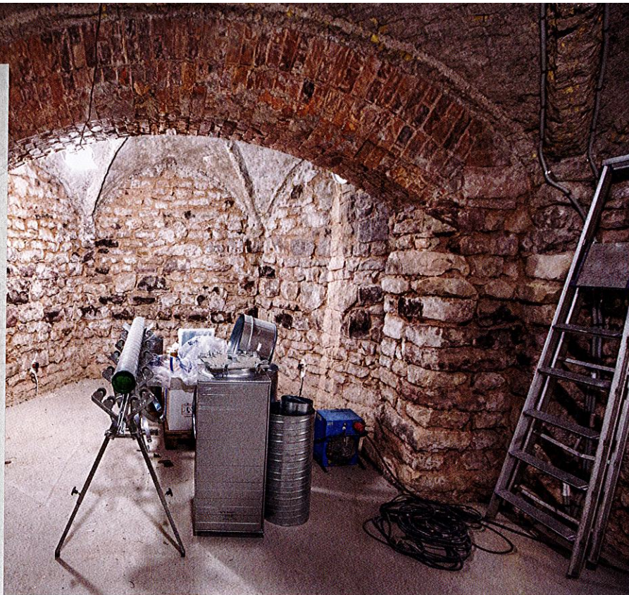
Huvudentrén till den nya samlingsalen blir via den före detta likboden, som nyttjas som förråd sedan 1950-talet. Här blir det både ett café och en liten sakristia.
