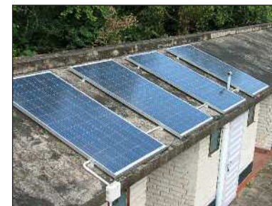
Solpaneler på Guest House. Skolan blir nu mer oberoende av det nyckfulla elnätet.
