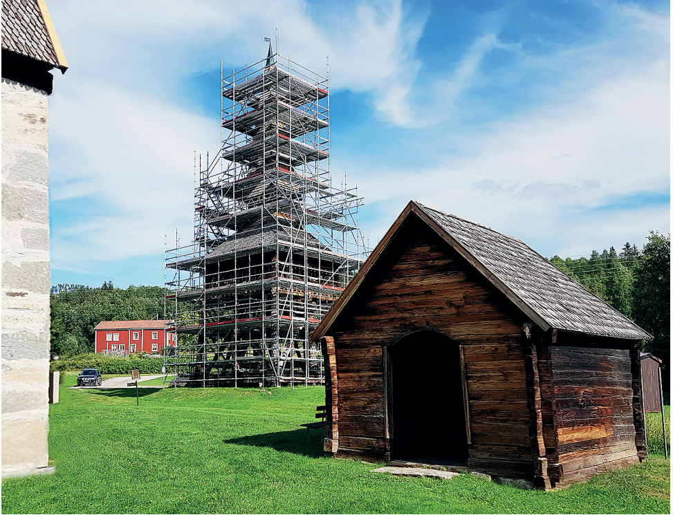
Klockstapeln vid Lidens Gamla Kyrka inför underhållsarbete 2022. Del av kyrkan syns till vänster och Stigporten till höger. Foto: Arne Johansson.
