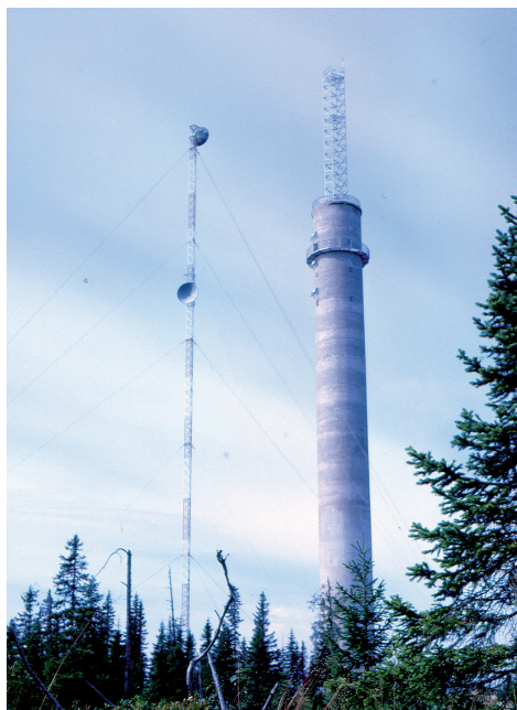
Det färdiggjutna Rallåstornet. Installationer inomhus pågick för fullt. Fackverksmasten (till vänster) på marken monterades ned efter att tornet färdigstälts. Foto år 1962.
