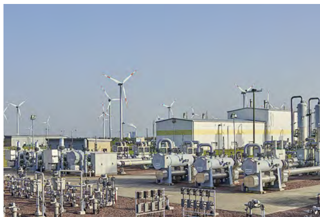
Abbildung 12: Gasspeicher Bad Lauchstädt der VNG Gasspeicher GmbH – In den nächsten Jahren soll im Mitteldeutschen Revier in unterirdischen Kavernen auch grüner Wasserstoff gespeichert werden. (Quelle: VNG/Torsten Proß, Jeibmann Fotografik ( https://vng.de/de/fotogalerie/fotos-gasspeicher ))
