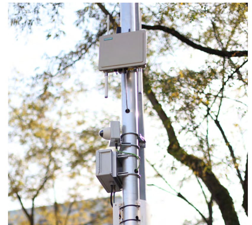
Infrastruktur: Erfassung des Verkehrsumfelds und Lokalisierung der Fahrzeuge
