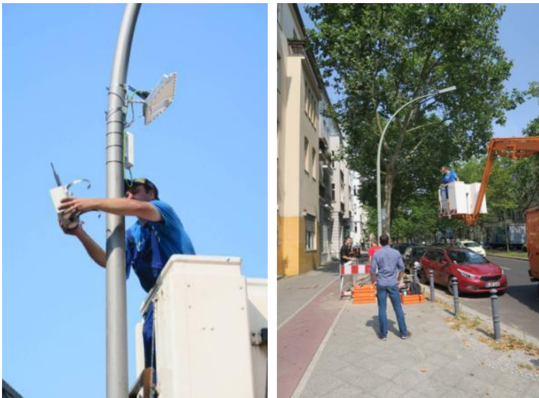
Abbildung 5: Installation der Radarsensoren und der weiteren Komponenten (u. a. Gateway, WLAN)
