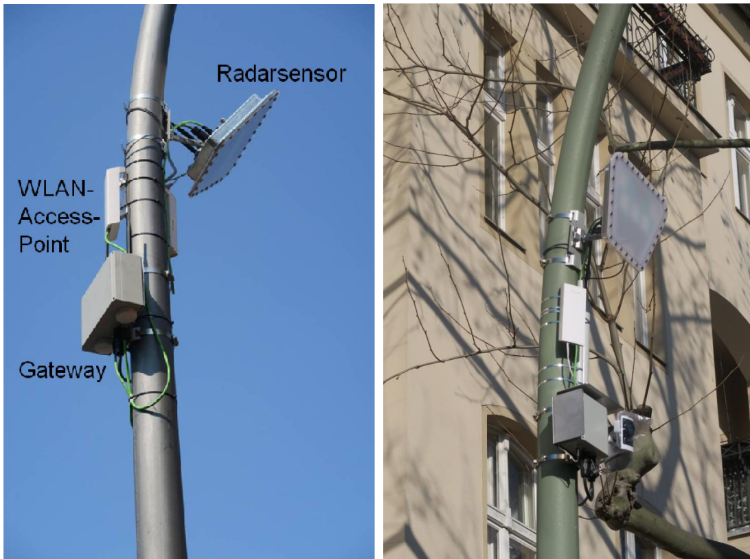
Abbildung 6: Fertige Installationen mit Radarsensoren, Kamera, Gateway und WLAN-Repeater
