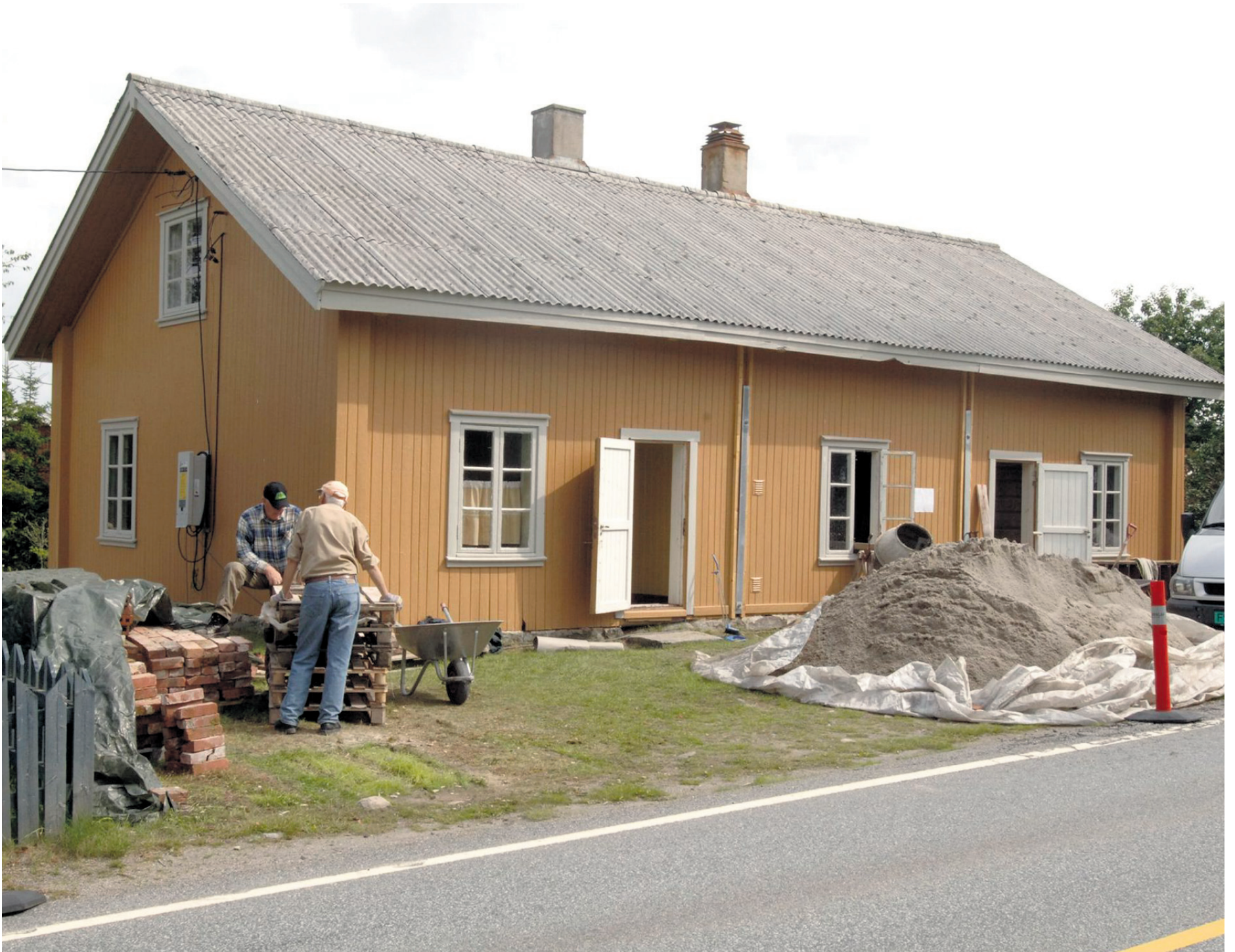
Idd og Enningdalen historielag får 50.000 kroner til brannsikring av den gamle forpakterboligen.
