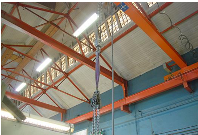
Interiör från kraftstationen. Den har sedan 1963 använts som verkstad. Här finns lanterninens fönsterrader bevarade bakom den utvändiga plåten. Foto LKU 2021.
