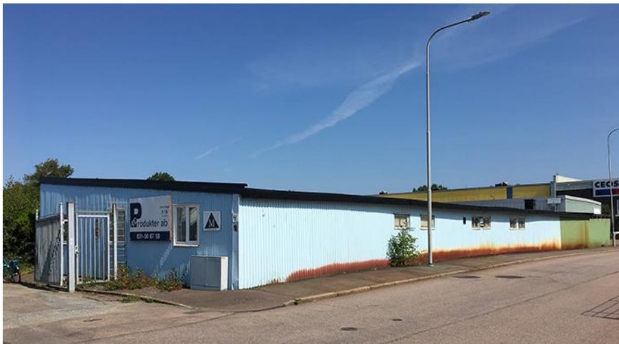
Lergodsgatan 4. Den låga plåtklädda fasaden mot Lergodsgatan har inte rustats upp på länge och ger ett närmast organiskt intryck. Foto Lena Knutson Udd 2020.
