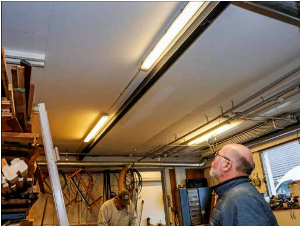
VB Byggeindustri har fået nye lysarmaturer med led-lys. Investeringen var større, end firmaet som udgangspunkt havde regnet med, men Nils Henrik Christiansen er glad for det nye energibesparende lys.
