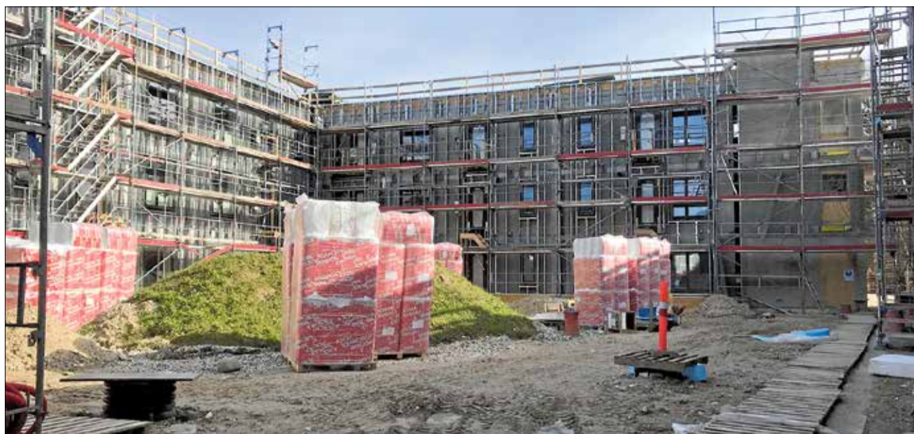
Byggematerialerne ligger og flyder i gården af det ufærdige byggeprojekt Seniorbofællesskabet Midgård. Arbejdet gik i stå, da entreprenørfirmaet B. Nygaard Sørensen gik konkurs i januar. Foto: Mikkel Kjølby
