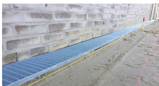
Sokkelrenden monteret og grus afrettet så det er klart til udlægning af fliser. Risten møder belægningen uden ekstra kant.
