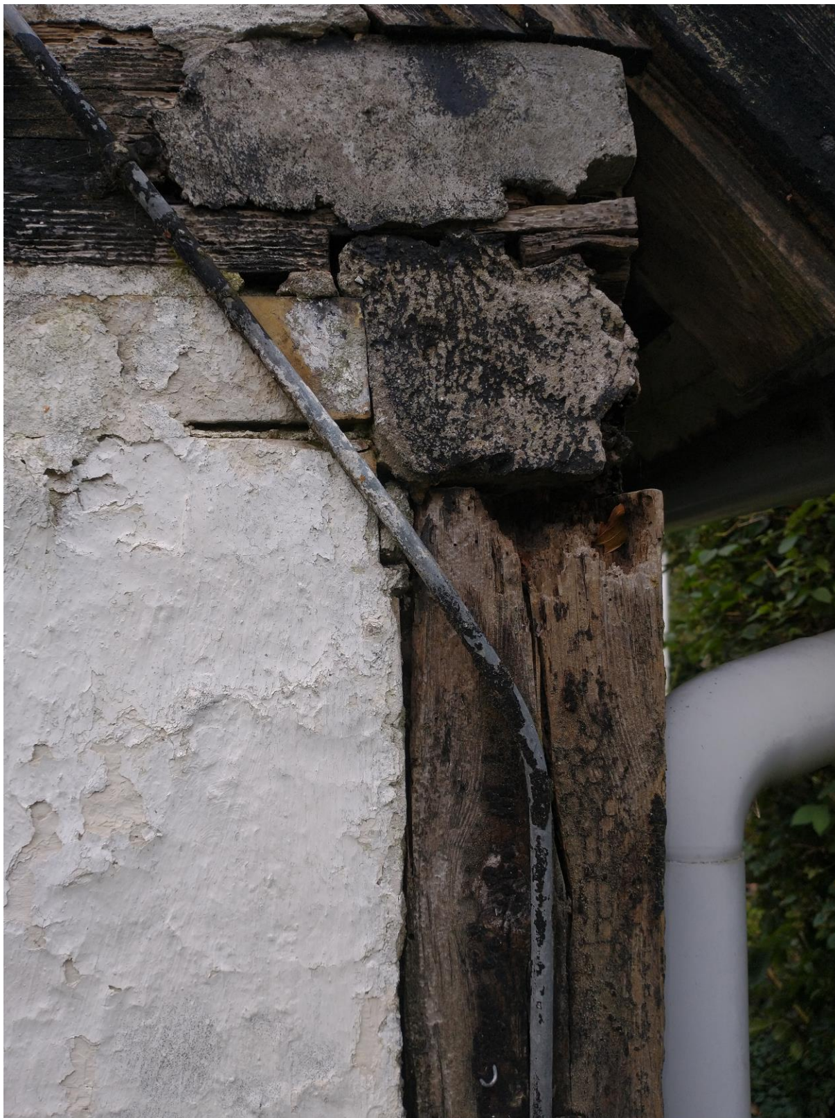
Billede 5. Gavl mod haven, hvor der er omfattende råd, og bæreevnen i muren er forsvundet.
