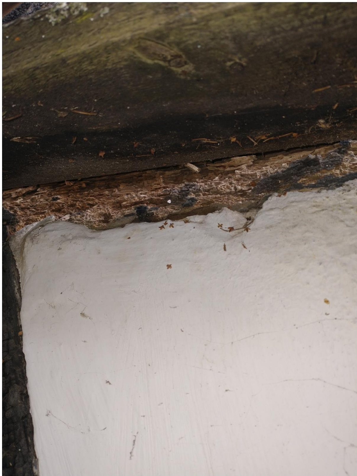
Billede 2. Råd i toprem i gavl, hvor topremnen er forsvundet
