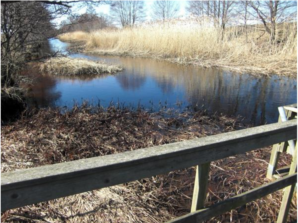
Figur 10. Pulkenbryggan och Graften uppströms bryggan 2010-04-15. Ansamlingar av sediment uppströms bryggan har gjort att vattendraget grundat igen totalt där och att växter fått fäste. Foto: Olof Jönsson.
