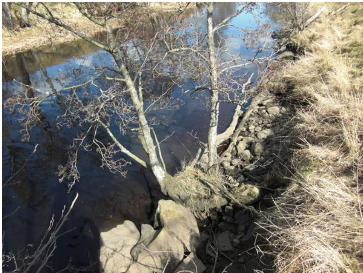
Figur 20. Alar på väg att falla ner i Möllerännan p.g.a. erosion 2010-04-16. Foto: Olof Jönsson.
