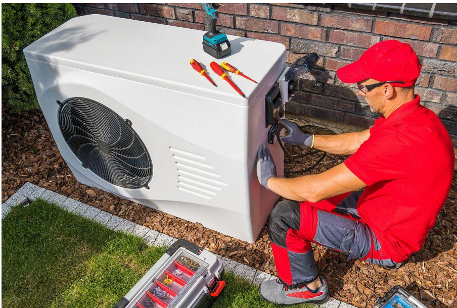
Installatie van een buitenunit van een moderne warmtepomp
