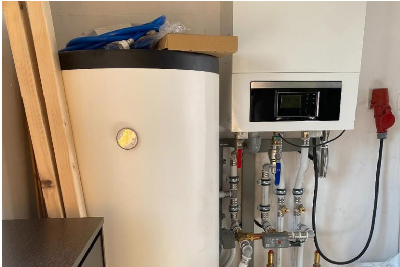
Cv-ketel met hybride warmtepomp-unit binnen. Naast de binneneenheid, is er ook een buiten-eenheid.
