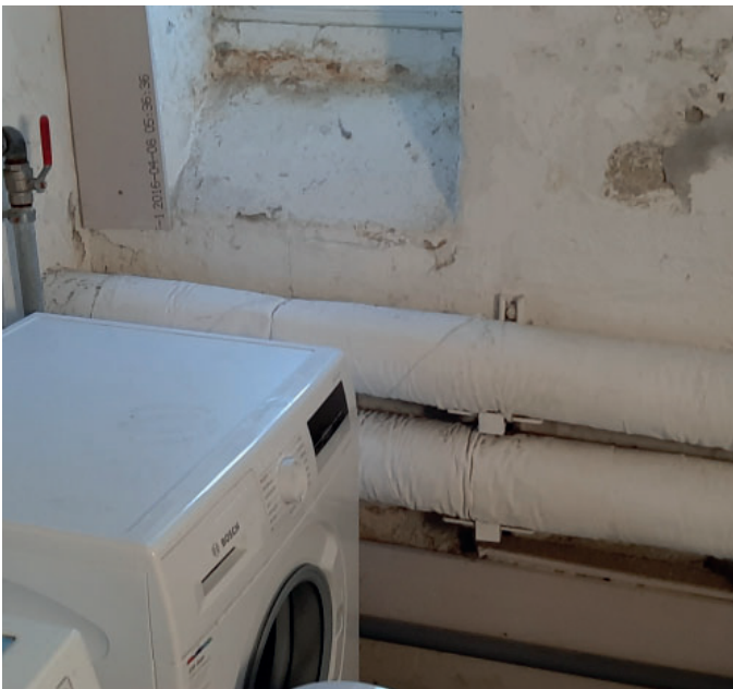
Ny varmecentral og tilslutning til fjernvarme
