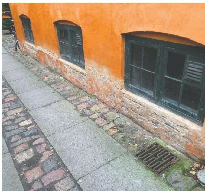
Den afskallede puds er tegn på fugtproblemer
