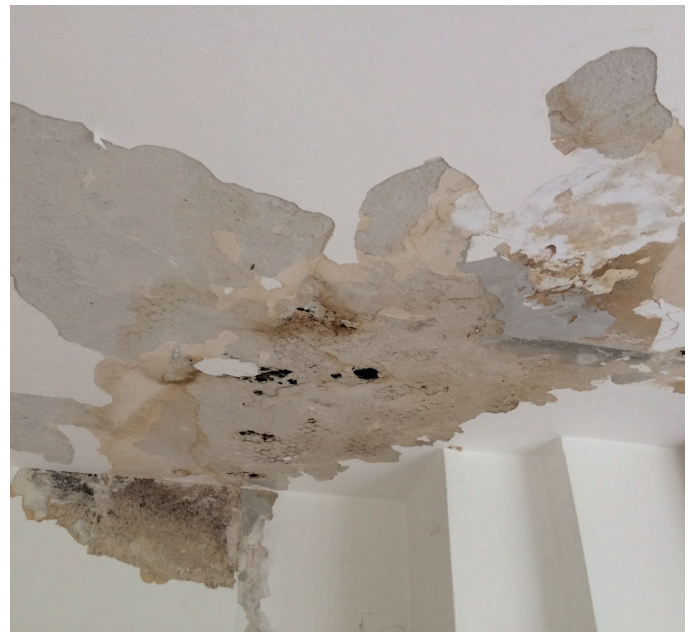
Tegn på fugt grundet uisoleret fladt tag
