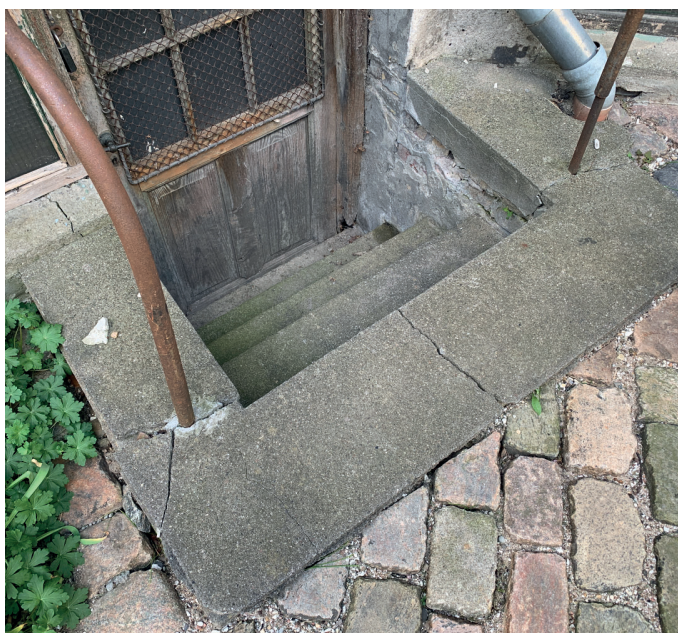
Kældertrapper og lyskasser skybrudssikres
