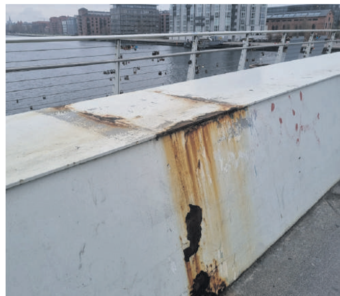
Bryggebroen er flere steder udsat for tydelige rustskader, der dog ikke påvirker sikkerheden på broen. Til sommer udbedres skaderne. Foto: Jesper Schou Hansen / Havnefronten.
