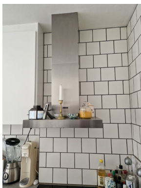
Frånluftsdonet blockeras av huv och kanal.
