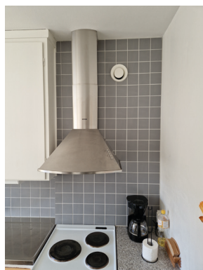
Frånluftsdonet ej blockerat.
