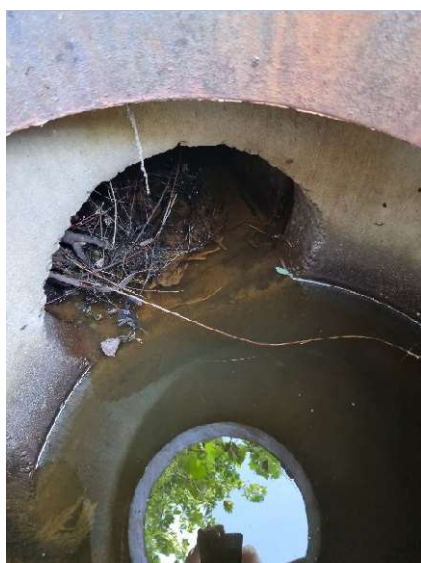
En stor rot klump i ledning mellan Klockbojsvägen och Fyrbåksvägen
