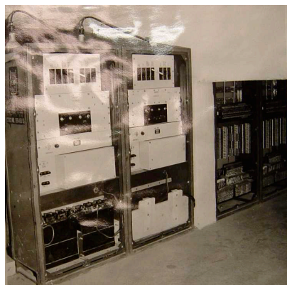
Strömstativ med batterier
