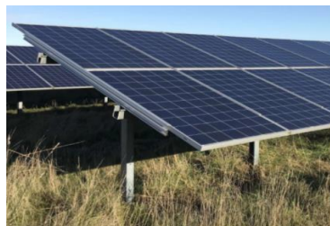
Solcellspaneler på enkelstativ (bildkälla. www.ri.se )
