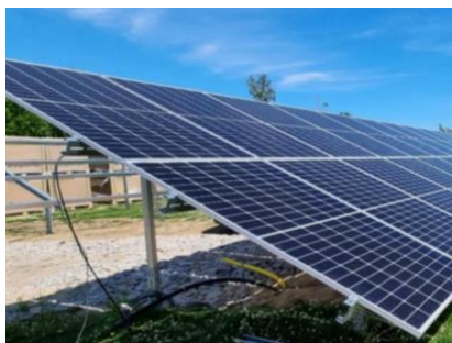
Figur 10 Solcellspaneler på stativ (bildkälla. www.sakofallenergi.se )
