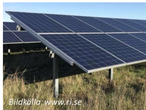
Figur 8. Solcellspaneler på enkelstativ
