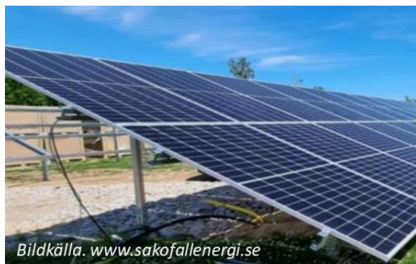
Figur 8. Solcellspaneler på stativ
