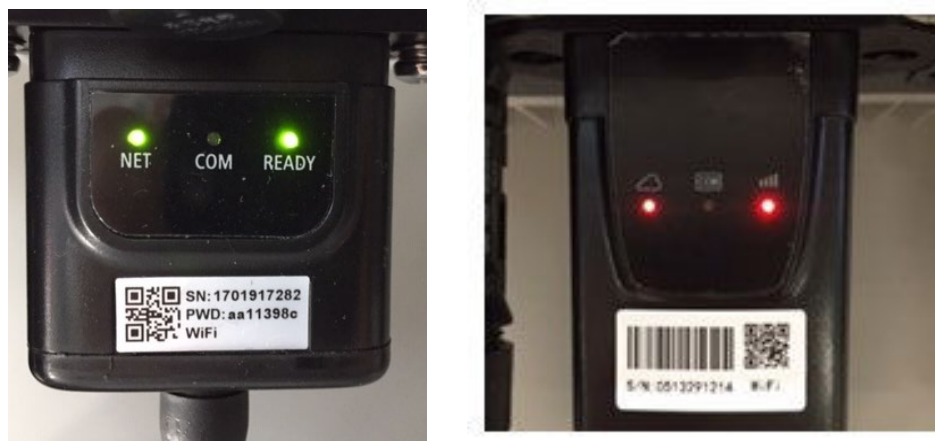
Figura 92 – Stato di comunicazione irregolare tra inverter e WiFi
