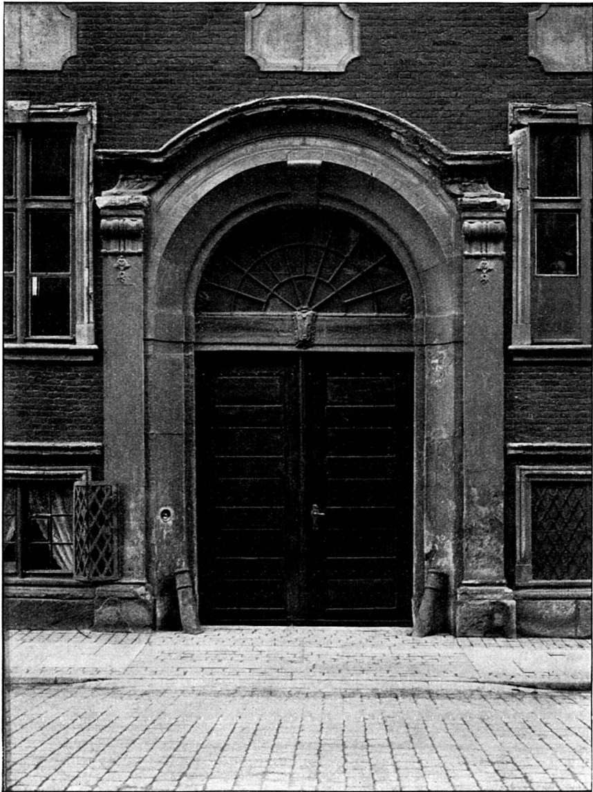
Paa Grev Frijs' Paa er Ødelæggelsen af Portens Sandstensbue og Pilastre i fuld Gang.
