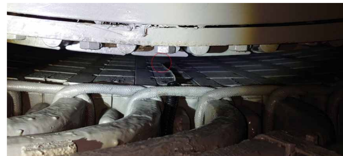
Magnetfeltmåler limt på stator i luftgapet på generator.
