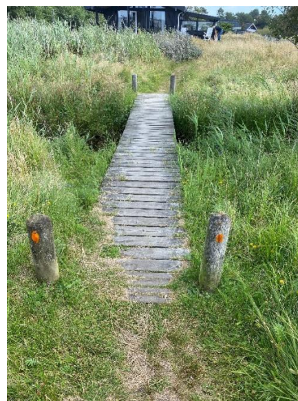
Broen mellem Nonboevej og Hanevej/Dalen har efterhånden set bedre dage.
