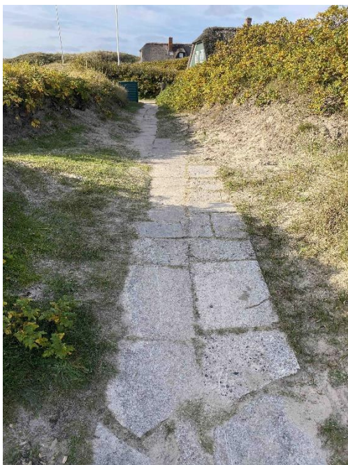
Badesti 4 øst: Flise belægningen ud mod Sønderklit. Flere fliser bør udskiftes og graves fri.
