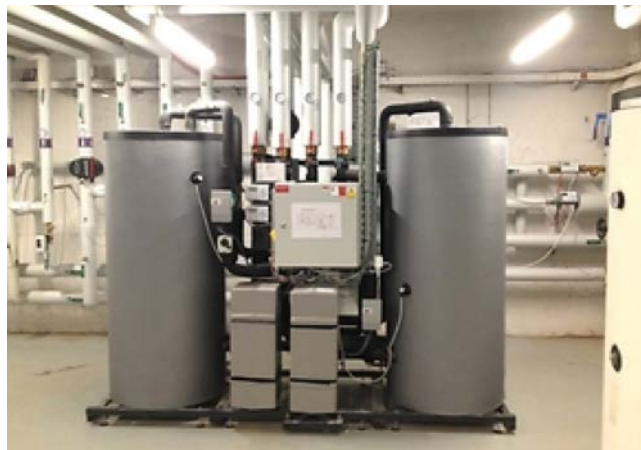
Figur 50 - Danfoss varmegenvindingsunit (HRU) til varmegenvinding fra et køleanlæg (Kilde: https://www.energy-supply.dk/announcement/view/103768/overskudsvarme_fra_koelanlaeg_bruges_som_fjernvarme )
