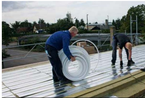
Figur 33 - Slangerne til varmepumpe i tagkonstruktion [1]
