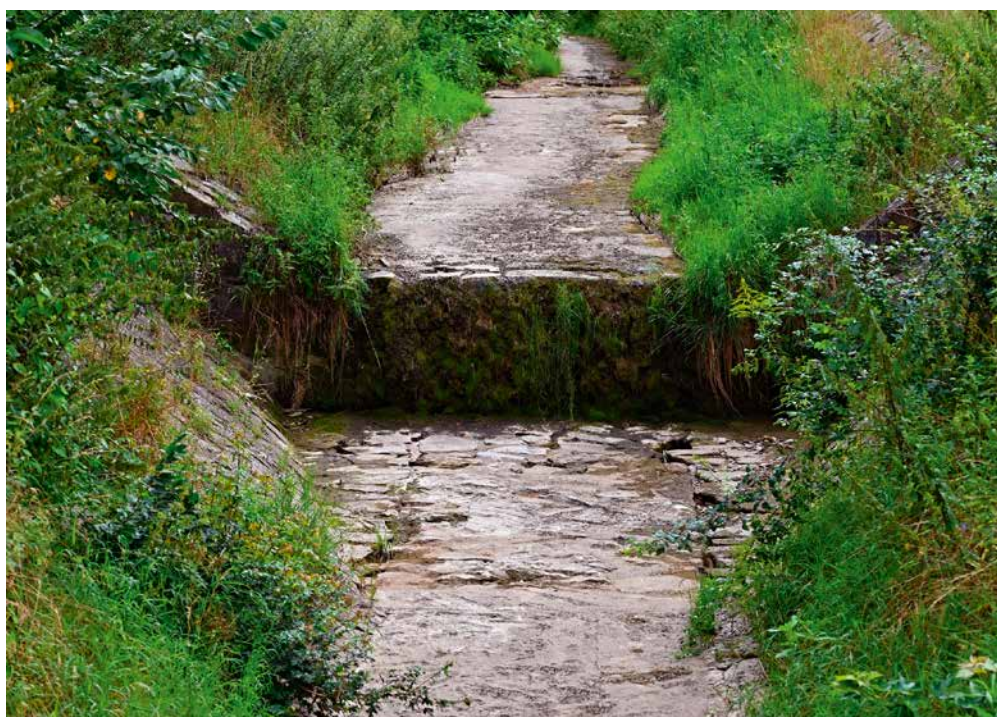
Volgens beheerders is grote schade opgetreden aan vegetatie en fauna van het natuurdoeltype Beek en bron. Dit is te zien aan de achteruitgang van de macrofauna, zeldzame vissoorten zoals de beekprik en onderwaterplanten.
