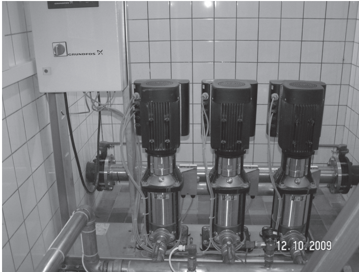
3 stk. Grundfos rentvandspumper
