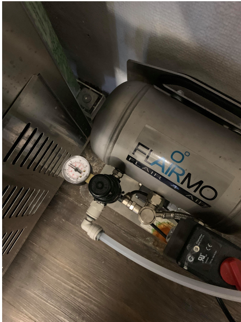
Figur 1.7. Dette er kompressoren. Er der tryk på manometeret - og er kompressoren tændt?
