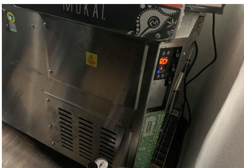
Figur 1.6. Dette er postmixanlægget er de under 5 grader?
