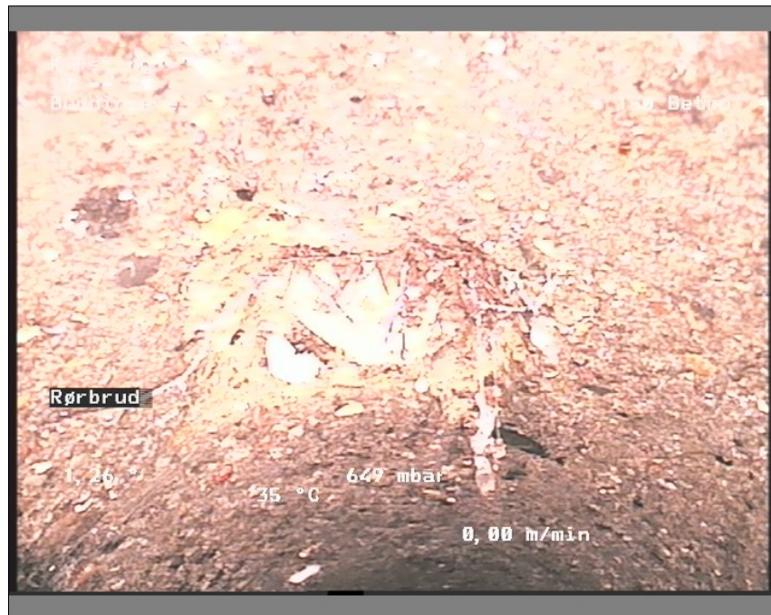
Foto: 19-2012573725-29-05-18_A.JPG, Medie #:: De Engelske _0, 00:05:48 57,97m, Rørbrud klasse 3, fra urref 10 til urref 12, Brud
