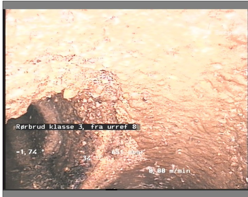
Foto: br 18-br1912261212-29-05-18_A.JPG, Medie #:: De Engelske _0, 00:04:22 8,47m, Rørbrud klasse 3, fra urref 8 til urref 11, Brud / skal laves med en gr foring
