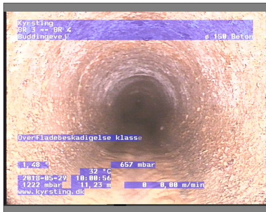
Foto: BR 3-BR 41001065-29-05-18_A.JPG, Medie #: De Engelske _0, 00:02:45 11,23m, Overfladebeskadigelse klasse 3, fra urref 01 til urref 12, Stop
