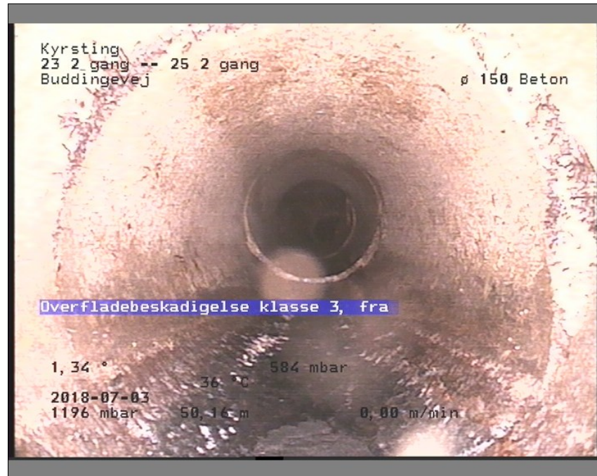
Foto: 23 2 gang-25 2 gang09411629-29-05-18_A.JPG, Medie #: De Engelske _0, 00:12:25 50,16m, Overfladebeskadigelse klasse 3, fra urref 01 til urref 12, Stop
