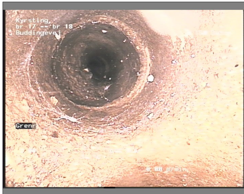
Foto: br 17-br 1812090640-29-05-18_A.JPG, Medie #: De Engelske _0, 00:13:49 29,82m, Grenrør klasse 0, urref 10 / sten obs i ledning, mulig brud
