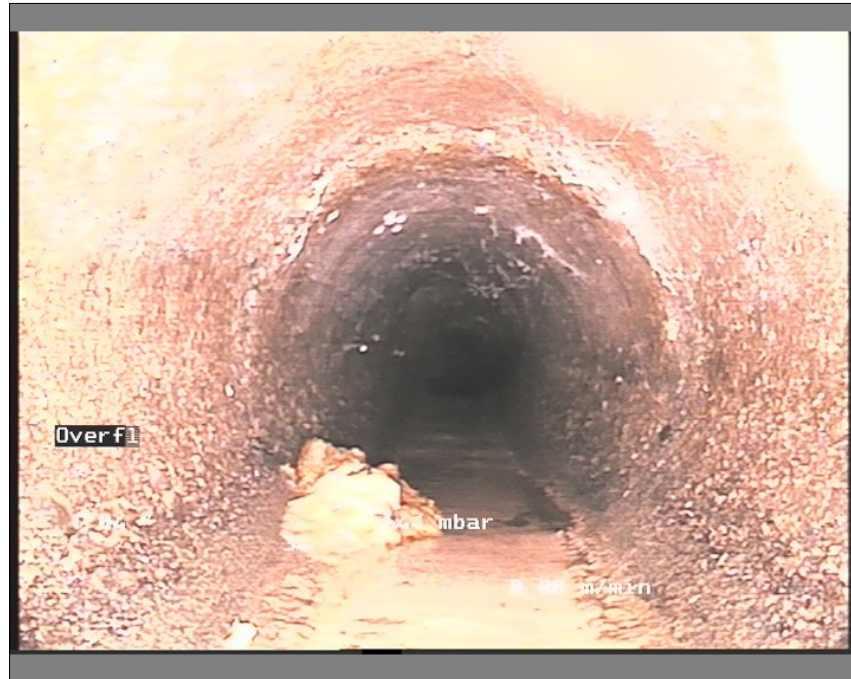
Foto: br 17-br 1812033634-29-05-18_A.JPG, Medie #: De Engelske _0, 00:09:47 25,87m, Overfladebeskadigelse klasse 3, fra urref 01 til urref 12, Stop
