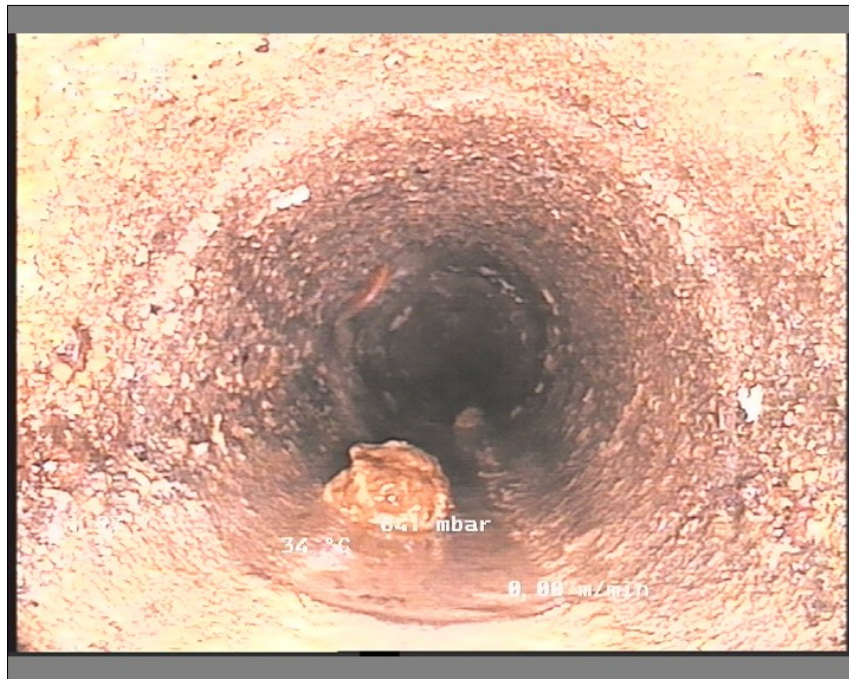
Foto: 16-1711254620-29-05-18_A.JPG, Medie #:: De Engelske _0, 00:00:37 14,56m, Overfladebeskadigelse klasse 3, fra urref 1 til urref 12, Start
