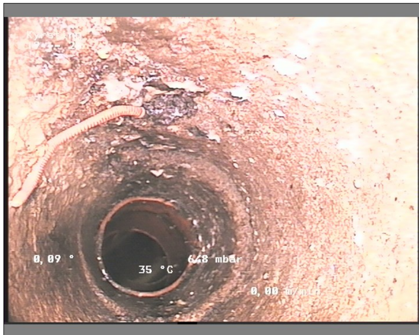
Foto: 19-2012504011-29-05-18_A.JPG, Medie #:: De Engelske _0, 00:02:15 43,18m, Rørbrud klasse 3, fra urref 6 til urref 11, Brud / BRUD I GRENRØR
