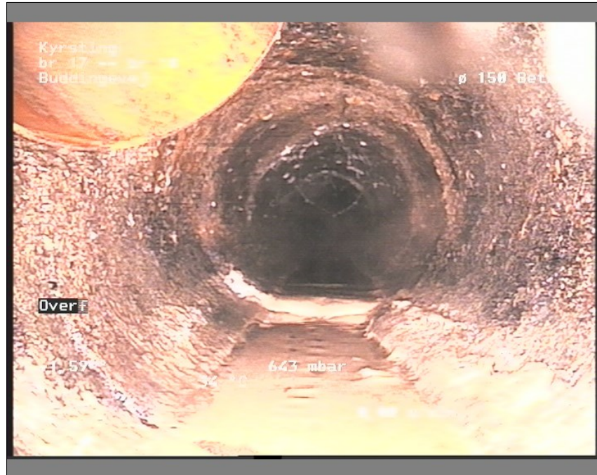
Foto: br 17-br 1812013629-29-05-18_A.JPG, Medie #: De Engelske _0, 00:08:46 23,39m, Overfladebeskadigelse klasse 3, fra urref 1 til urref 12, Start
