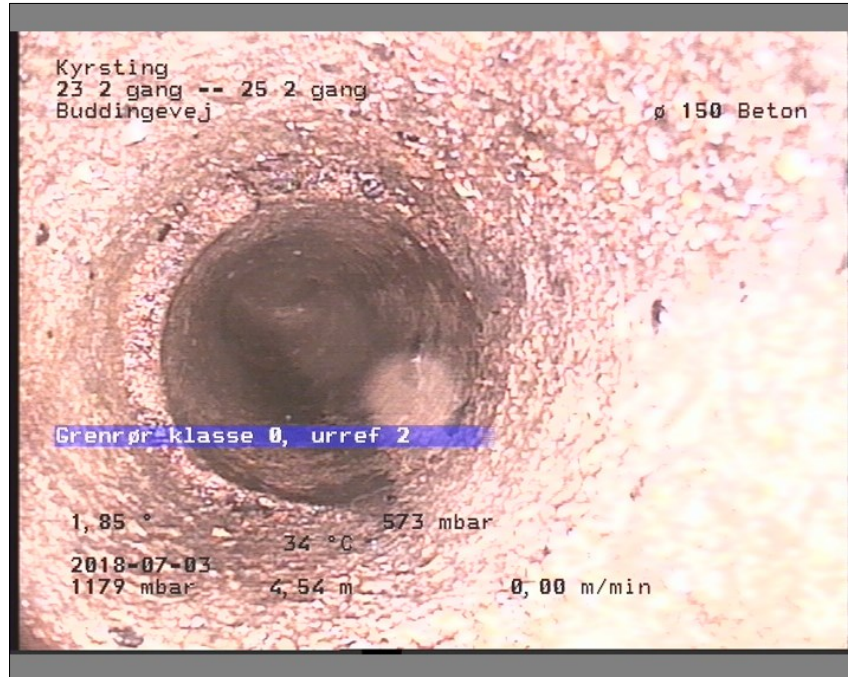
Foto: 23 2 gang-25 2 gang0923597-29-05-18_A.JPG, Medie #: De Engelske _0, 00:02:02 4,54m, Grenrør klasse 0, urref 2
