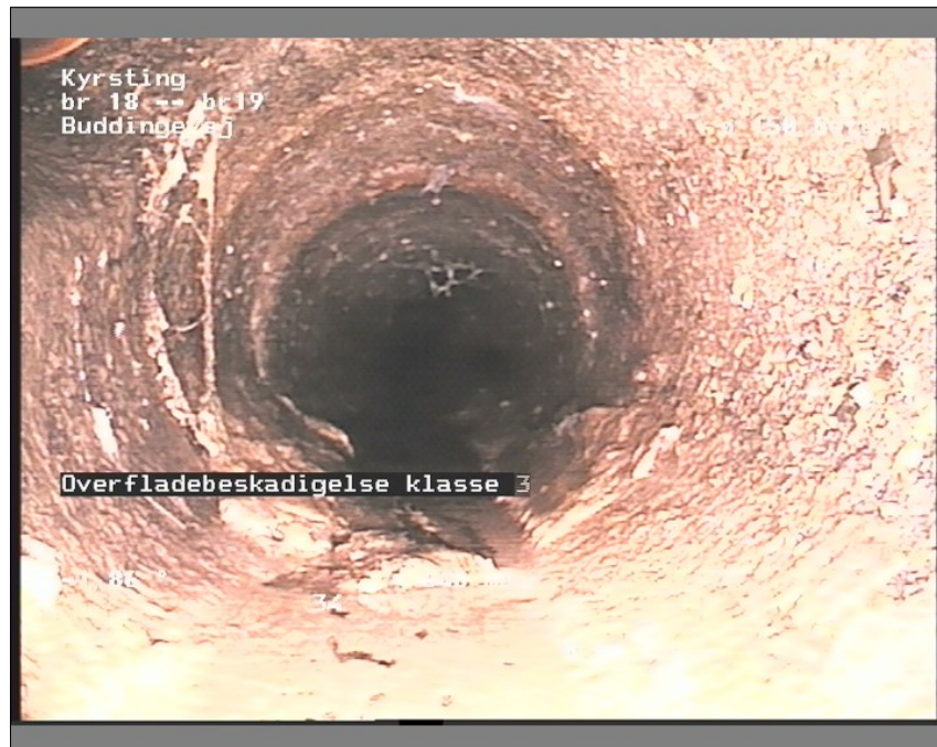
Foto: br 18-br1912315823-29-05-18_A.JPG, Medie #:: De Engelske _0, 00:07:22 15,64m, Overfladebeskadigelse klasse 3, fra urref 1 til urref 12, Start
