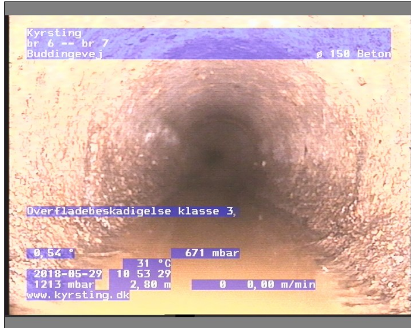
Foto: br 6-br 71053393-29-05-18_A.JPG, Medie #: De Engelske _0, 00:01:21 2,8m, Overfladebeskadigelse klasse 3, fra urref 2 til urref 10, Start
