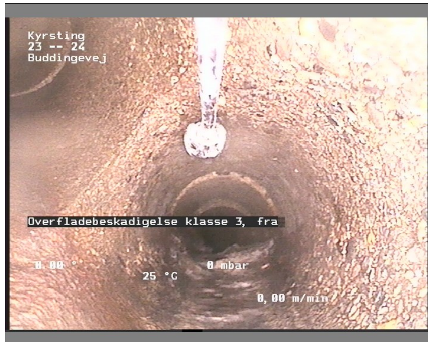
Foto: 23-240953497-29-05-18_A.JPG, Medie #.: De Engelske _0, 00:01:39 2,97m, Overfladebeskadigelse klasse 3, fra urref 1 til urref 12, Start
