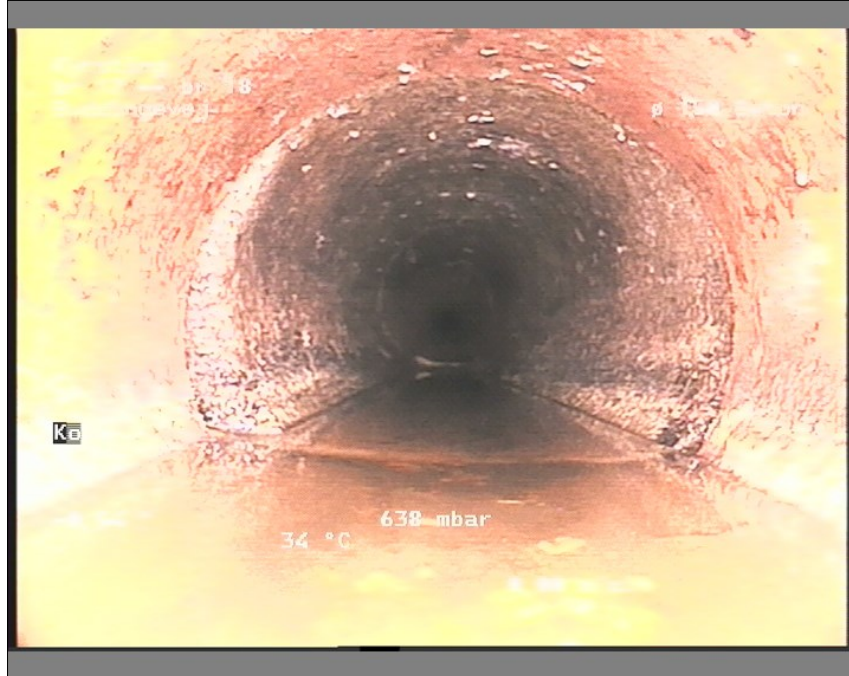
Foto: br 17-br 181144097-29-05-18_A.JPG, Medie #.: De Engelske _0, 00:00:57 2,74m, Konstruktionsændring klasse 2, Dimensionsændring, Materialeændring
