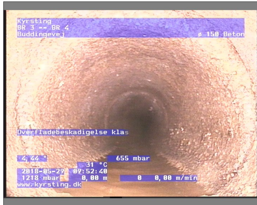
Foto: BR 3-BR 40952503-29-05-18_A.JPG, Medie #: De Engelske _0, 00:00:09 0m, Overfladebeskadigelse klasse 3, fra urref 1 til urref 12, Start
