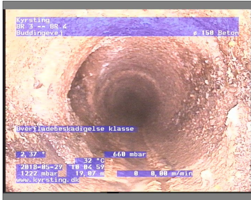
Foto: BR 3-BR 410051012-29-05-18_A.JPG, Medie #:: De Engelske _0, 00:05:11 19,07m, Overfladebeskadigelse klasse 3, fra urref 1 til urref 12, Start
