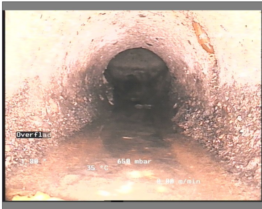
Foto: 19-2012584026-29-05-18_A.JPG, Medie #:: De Engelske _0, 00:06:40 63,89m, Overfladebeskadigelse klasse 3, fra urref 3 til urref 9
