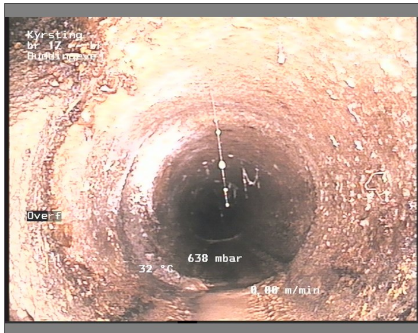
Foto: br 17-br 1811481914-29-05-18_A.JPG, Medie #: De Engelske _0, 00:03:45 9,22m, Overfladebeskadigelse klasse 3, fra urref 3 til urref 11
