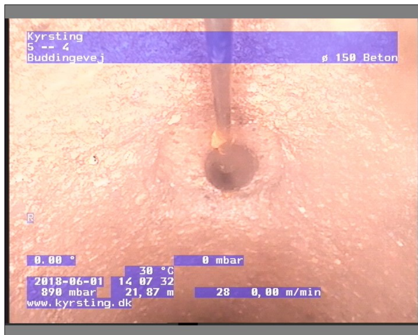
Foto: 4-514074821-29-05-18_A.JPG, Medie #.: De Engelske _0, 00:06:02 21,49m, Rørbrud klasse 3, fra urref 11 til urref 1, Brud
