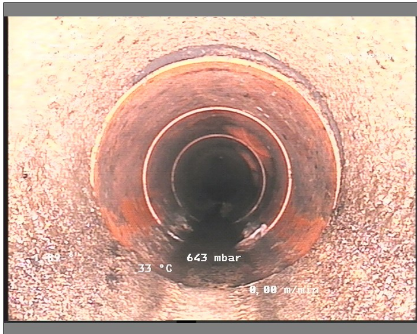
Foto: 15-2113363417-29-05-18_A.JPG, Medie #:: De Engelske _0, 00:05:17 24,51m, Konstruktionsændring klasse 2, Dimensionsændring, Materialeændring
