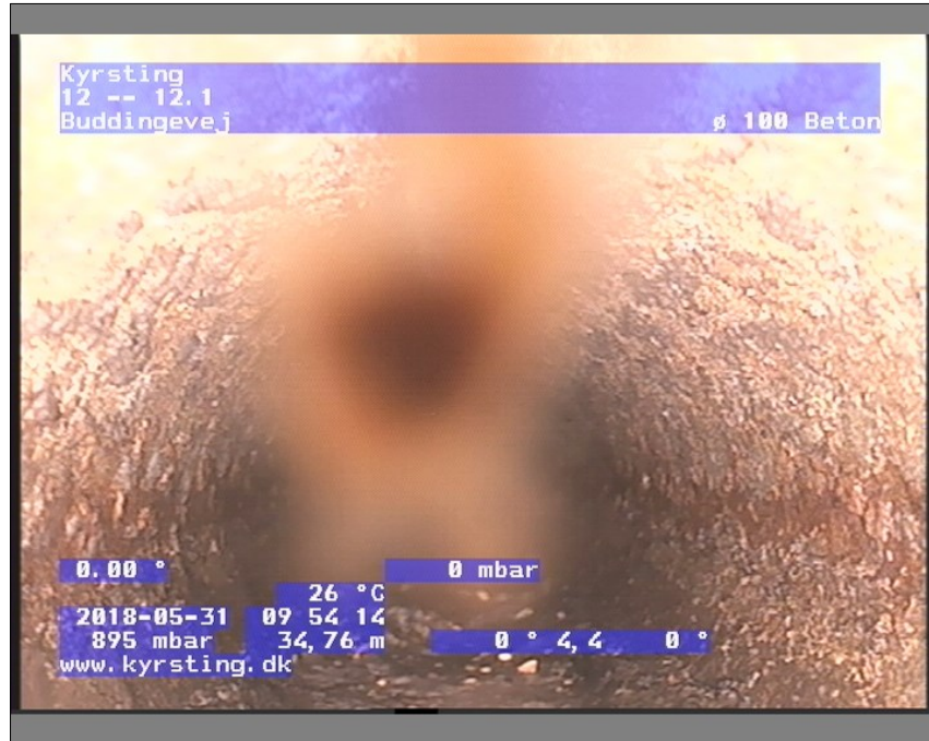
Foto: 12-12.109543735-29-05-18_A.JPG, Medie #.: De Engelske _0, 00:17:40 34,83m, Overfladebeskadigelse klasse 3, fra urref 02 til urref 11, Stop
