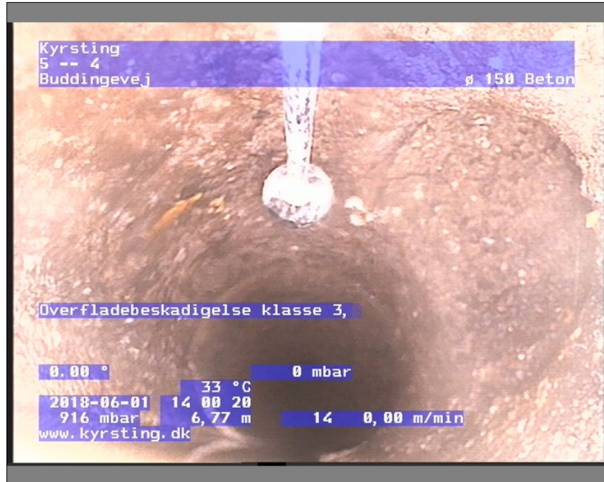
Foto: 4-514003710-29-05-18_A.JPG, Medie #:: De Engelske _0, 00:01:57 6,77m, Overfladebeskadigelse klasse 3, fra urref 1 til urref 12, Start
