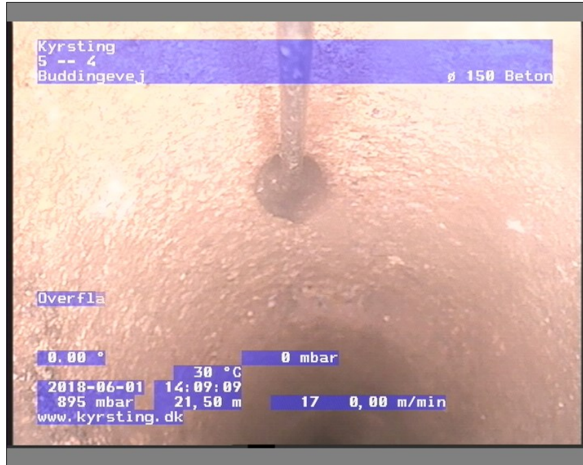
Foto: 4-514092623-29-05-18_A.JPG, Medie #: De Engelske _0 21,5m, Overfladebeskadigelse klasse 3, fra urref 01 til urref 12, Stop
