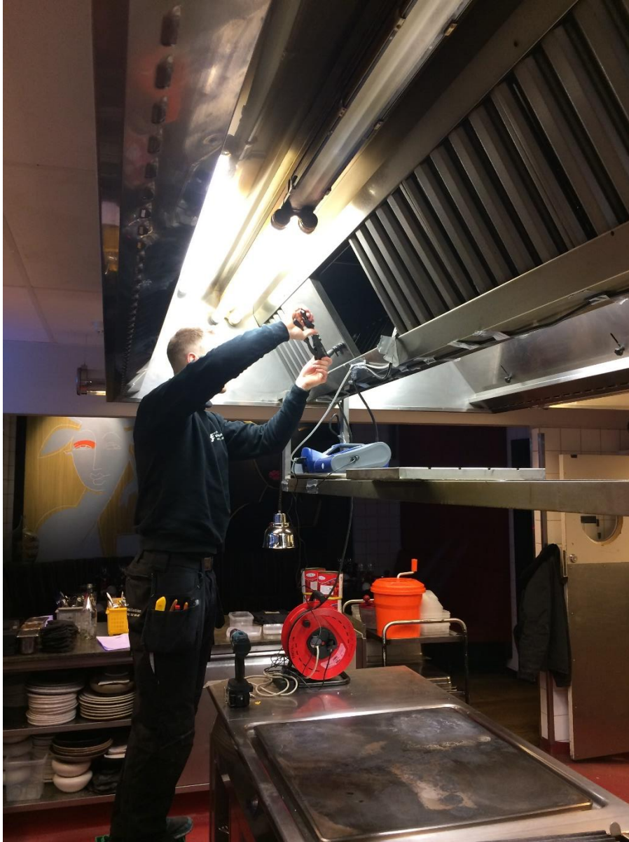
Figur 1: Installering af målestudse af HJE Ventilation til brug for isættelse af måleslanger og -prober til måling af partikelniveauer. Installeringen sker i emfanget umiddelbart over kogeplade og grill i restaurantkøkken.
