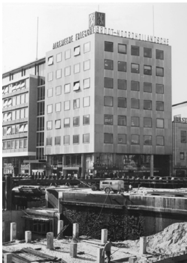
Hoek Westblaak-Coolsingel in 1968 ten tijde van de bouw van de metro (Stadsarchief Rotterdam)
