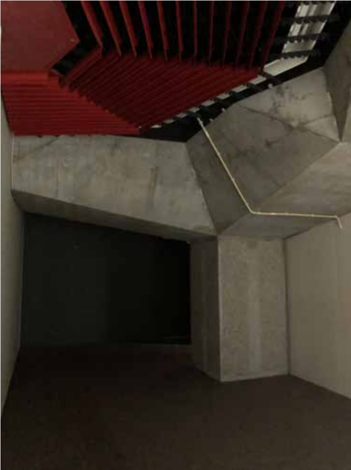
Luchtbehandelingselementen met lichtarmaturen onder de betonnen vuisten op de tweede verdieping, 2020
