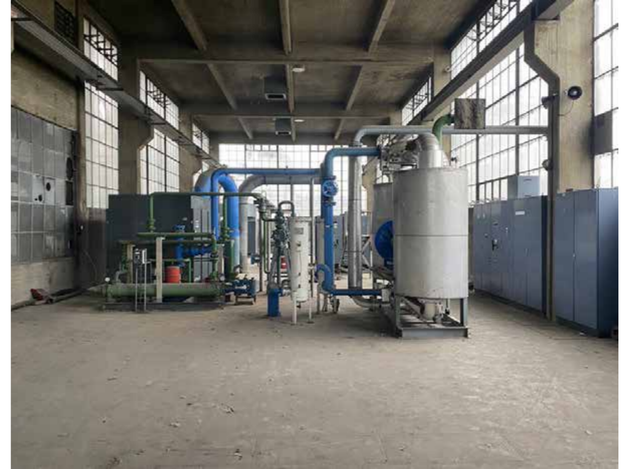
Interieurbeeld van de compressorenhal
