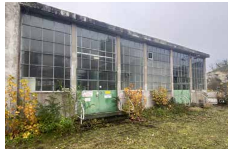
Royale glasvlakken in het Verdeelstation Zuid
