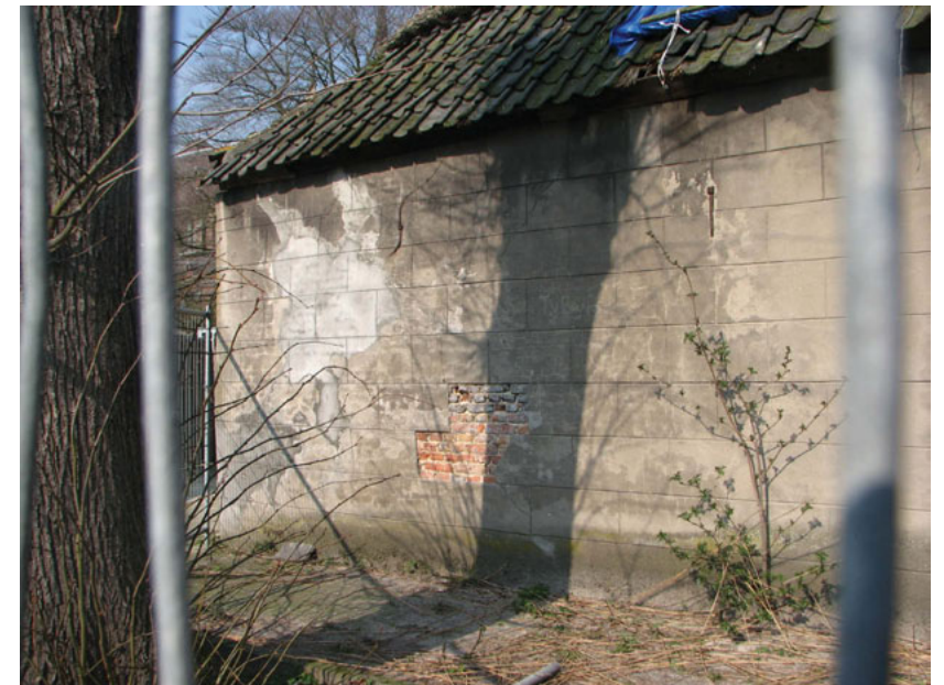
Zuidgevel (foto: 2007, voor restauratie), westzijde; pleisterwerk met schijnvoegen uitgevoerd in een ongeschilderde cementmortel. Bij de beschadiging is het rode metselwerk zichtbaar (XVIII)
