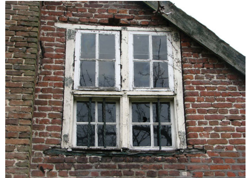
Oostgevel (foto: 2007, voor restauratie); het kruiskozijn van de opkamer. Opvallend is het ontbreken van een ontlastende rollaag boven het kozijn en het onrustig ogende metselwerk. Het kozijn is bij de restauratie vervangen
