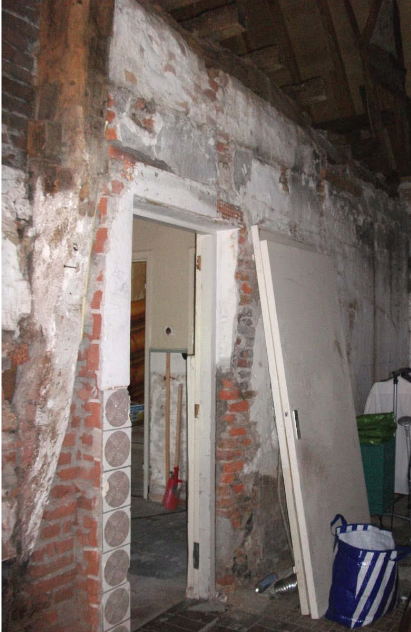
Ankerbalkgebint op as C; gebintstijl gezien vanuit de entreehal. Het gebint is in de 17 e eeuw ingemetseld. De zachte rode baksteen die ook in de kelder zichtbaar is ook hier gebruikt (foto: 2010, Remco Luyk)
