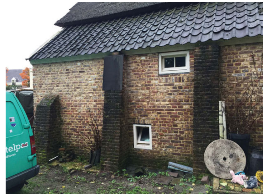
Noordgevel (foto: 2015); vernieuwd metselwerk van kelder en opkamer, uitgevoerd in oude steen verwerkt in kruisverband. De kozijntjes zijn vernieuwd en nu passend in het metselwerk opgenomen. Steunberen zijn nagemaakt (2005)
