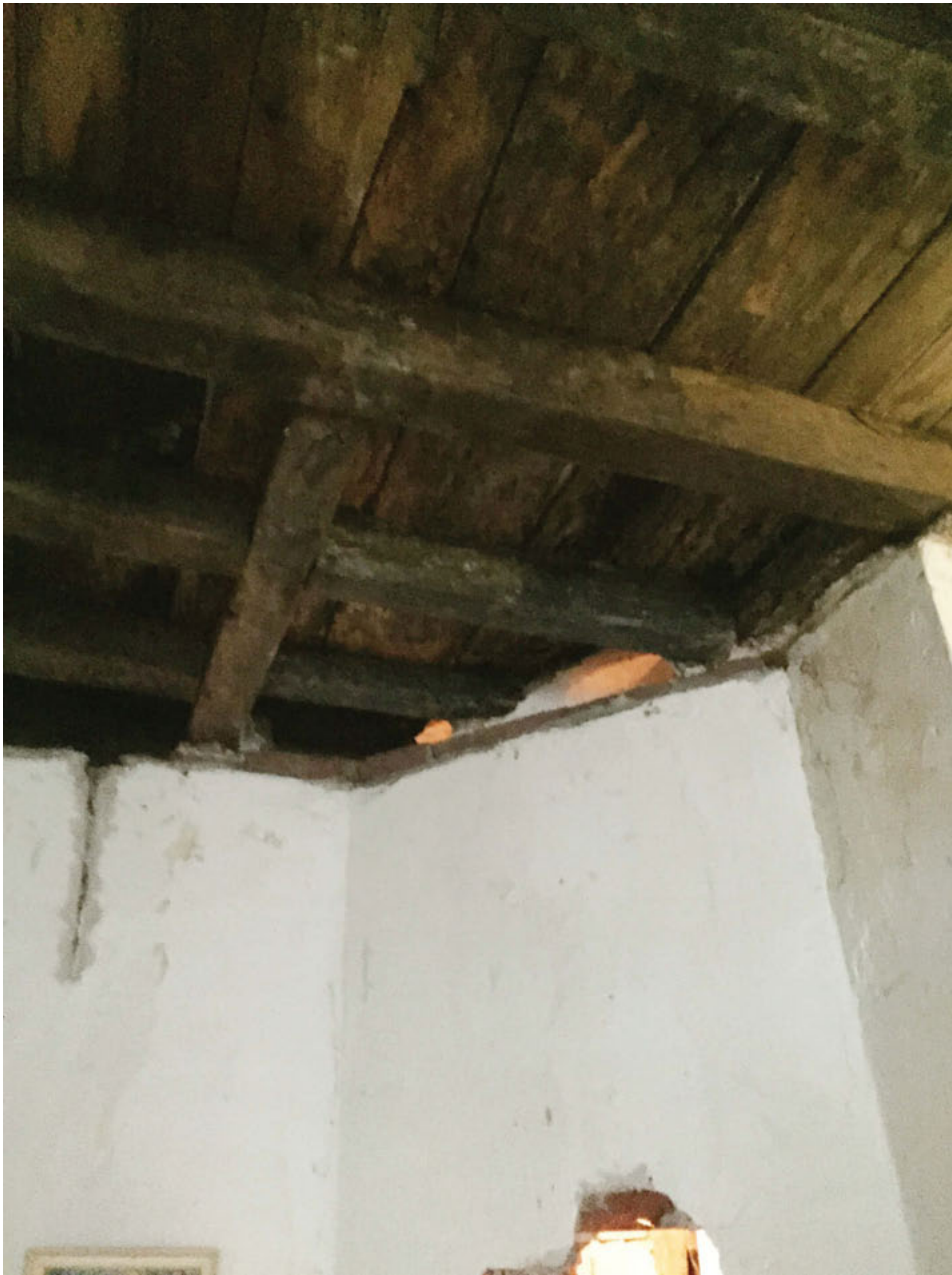
Balklaag boven Ruimte 2. Voor de schoorsteen langs zit in de balklaag een grote raveling (foto: 2015)
