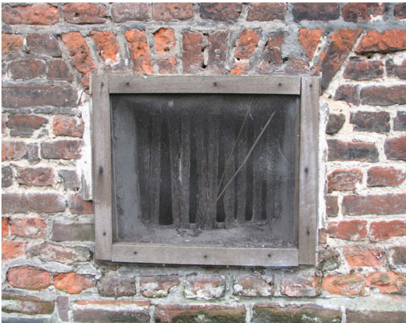
De zwaar getraliede ventilatieopening in de oostgevel (foto: 2007, voor restauratie). Dit 17e-eeuwse element is bij de restauratie vervangen door een houten kozijntje met valraam
