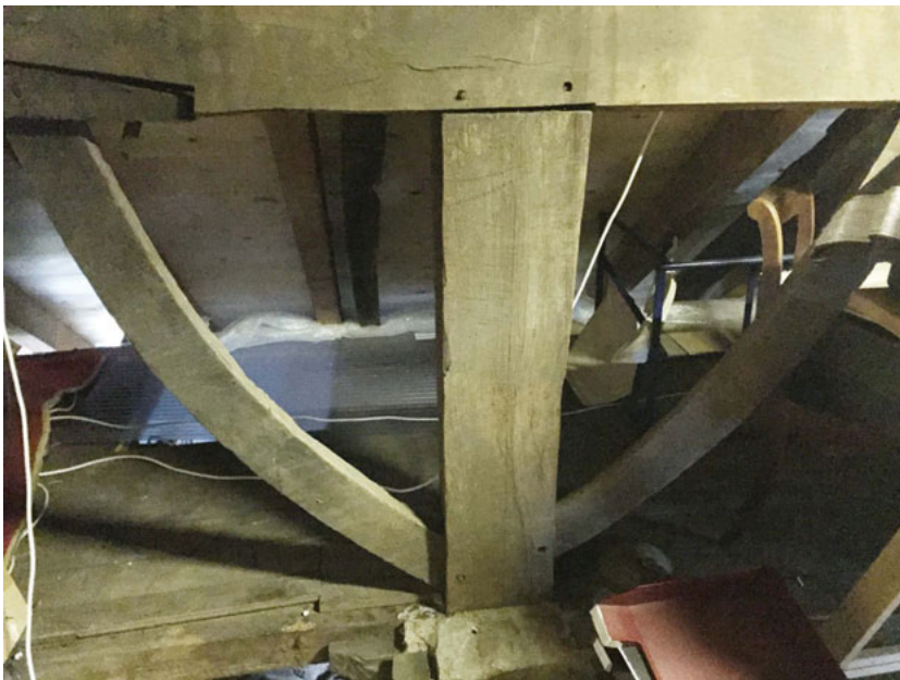
Ankerbalkgebint II; verbinding tussen stijl en gebintplaat zuidzijde. Op de stijl is het gekraste telmerk II zichtbaar. Boven de schoor links een schuine liplas. De linker gebintplaat stamt uit de eerste bouwphase (XVI), de gebintplaat rechts uit de tweede bouwphase (XVII) (foto: 2015)
