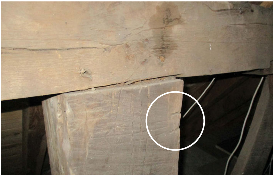
Verbinding gebintstijl-gebintplaat. Rechts op gebintstijl is gezaagd telmerk II zichtbaar (foto: 2015)
