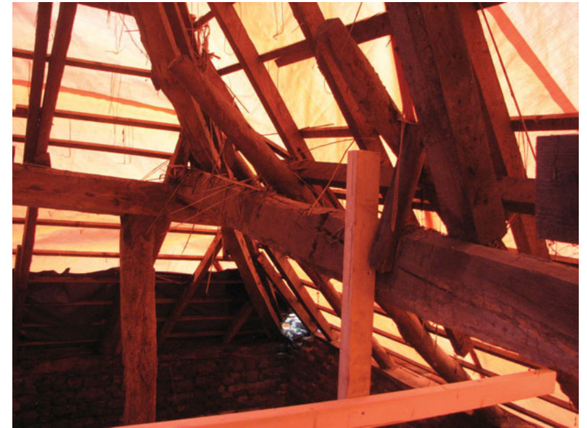
Kapconstructie (foto: 2007 voor restauratie). Na het verwijderen van de rietbedekking, gekeken naar de zuid-westhoek. De westelijke gebintplaat is gebroken. Er is een grote diversiteit aan sporen. Van geschilderde sparren tot gezaagde binten
