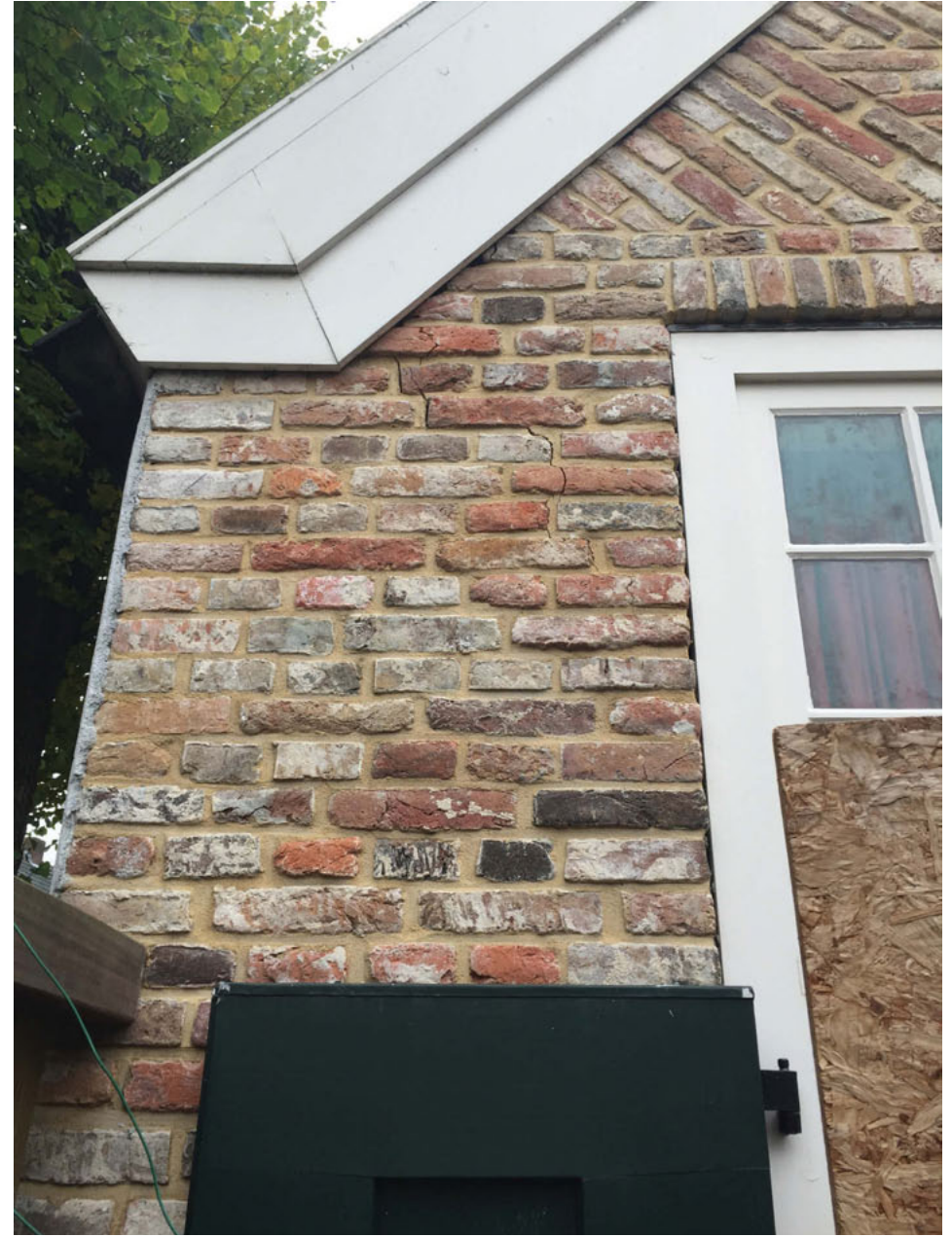
Oostgevel (foto: 2015); het metselwerk op de hoek van de zuidgevel is in 2005 tot en met het eerste kozijn vernieuwd, inclusief het vlechtwerk. In oude steen uitgevoerd, verwerkt in kruisverband. Het kozijn is vernieuwd. Opvallend is de scheur links van het kozijn
