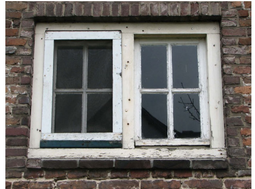
Oostgevel (foto: 2007, voor restauratie); kozijntje in Ruimte 3a, slaapkamer. Dit opvallende kozijntje met links een naar buiten draaiend raam en rechts een naar binnen draaiend deel is later toegevoegd. De stenen waarmee het kozijn is ingemetseld en de toegepaste keramisch waterslag wijzen op het eerste kwart van de 20 e eeuw
