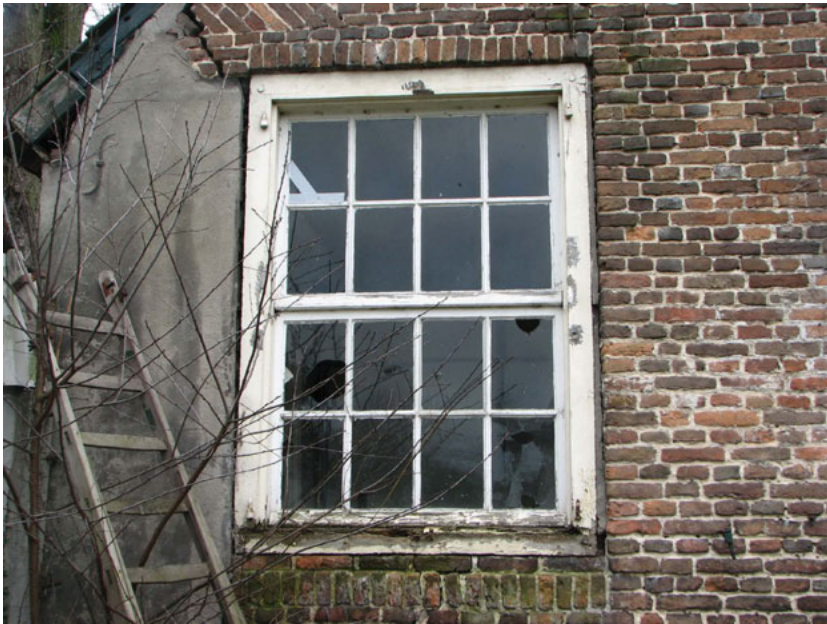
Oostgevel (foto: 2007, voor restauratie); sterke horizontale verplaatsing van de zuidgevel veroorzaakt ernstige scheuren in het metselwerk en heeft het kozijn losgetrokken. De verplaatsing is waarschijnlijk het gevolg van spatkrachten uit de kapconstructie
