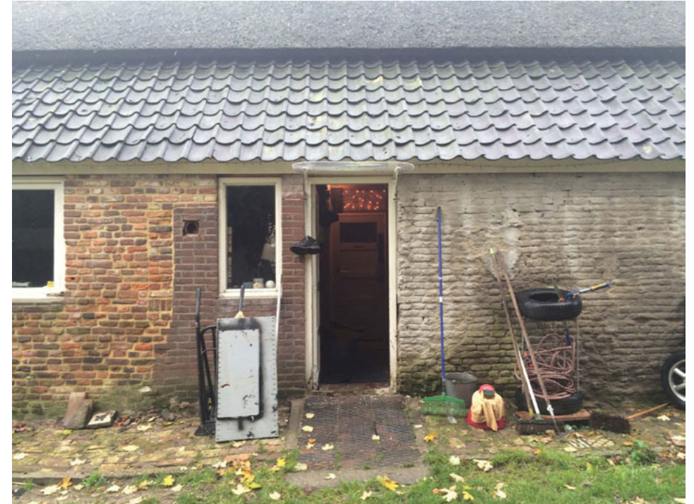
Noordgevel (foto: 2015), toegang tot voorruimte 7 (XXB). Voorruimte, vroeger onderdeel van de stal, is bij de woonruimte getrokken. Deurkozijn, smal keukenraam en het muurwerk tussen de kozijnen zijn uit die bouwphase. Links van het smalle keukenraam is een raamopening dichtgezet met oude steen. Het oude metselwerk is uitgevoerd als vuilwerk. De 4 lagen onder het boeideel zijn bij de restauratie in 2005 vernieuwd met oude steen
