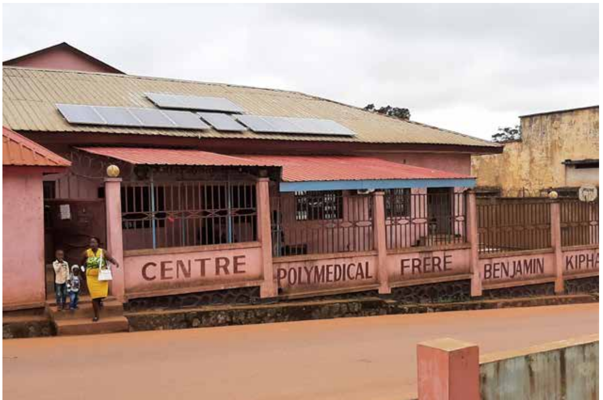
Zonnepanelen op het labo van het ziekenhuis
