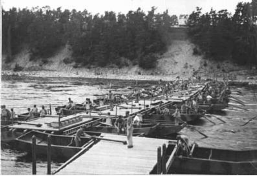
125 m lang pontonbro over Dalälven, ved Laxön; lasteevne 15 tons. Billedet er fundet på Internettet.
