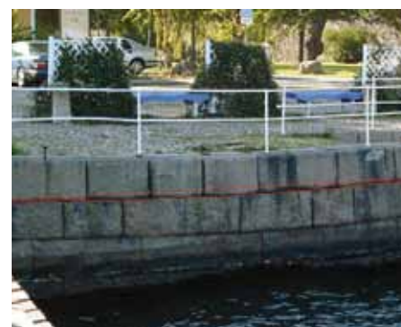
Bågande muröverbyggnad är ett vanligt tecken på skadade stenkistor, Kalmar 2008
