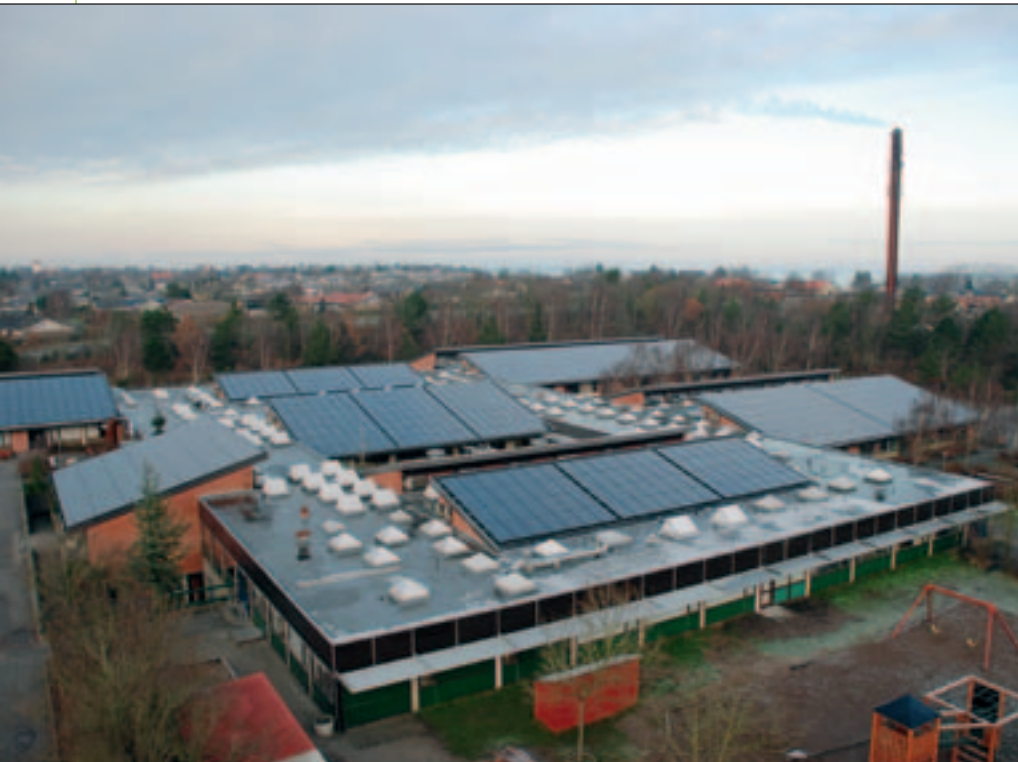
Skivehus School - 1225 m2 PV.
